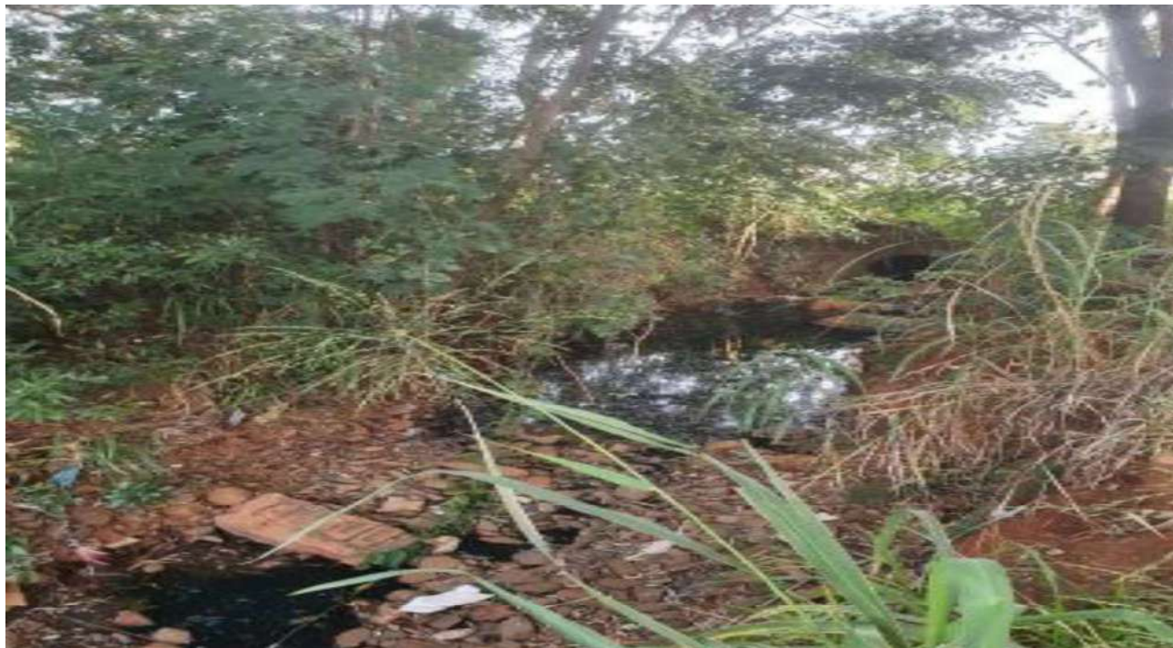
Imagem do processo erosivo.
