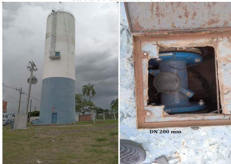
Figura 4.10. Reservatórios Jardim Nova Itirapina com seu macro medidor (DN 200 mm) na saída do abastecimento
