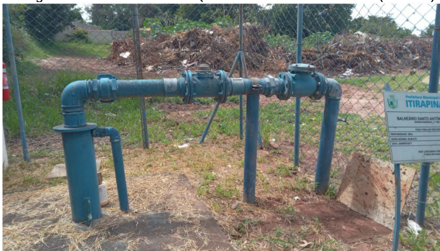
Figura 4.6. Cavalete do Poço Balneário Santo Antônio (Rua 04)
