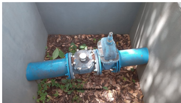
Figura 4.5. Saída reservatório apoiado (macro woltmann DN 200 mm)
