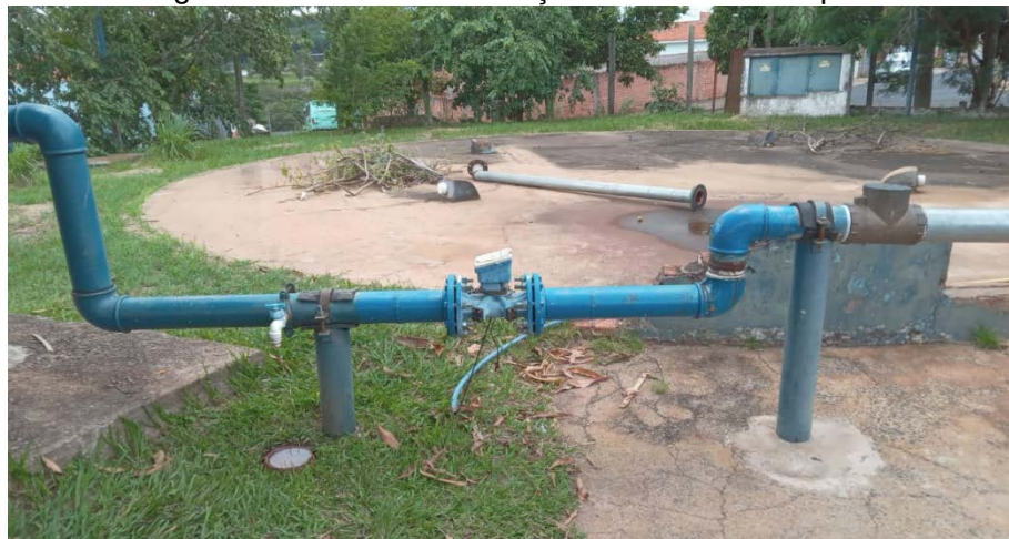
Figura 4.9. Cavalete do Poço Jardim Nova Itirapina
