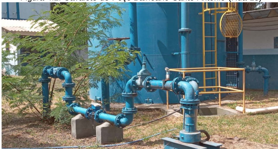
Figura 4.2. Cavalete do Poço Balneário Santo Antônio (Rua 13)
