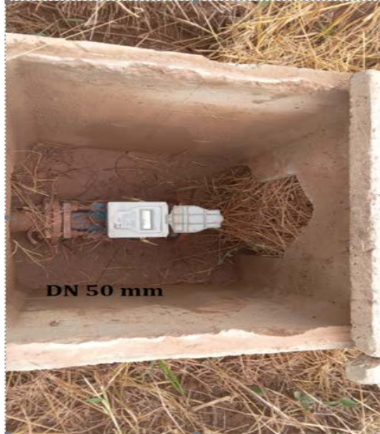
Macro Medidor Saída Reservatório DN 50 mm
