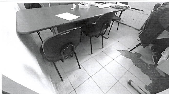
Foto 29 – piso vinílico com peças danificadas
