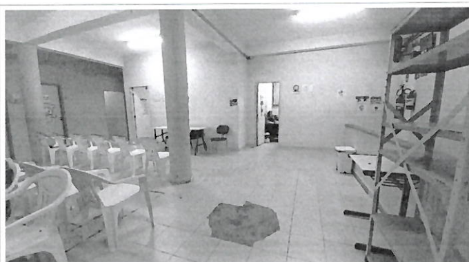
Foto 31 – piso vinílico com peças danificadas
