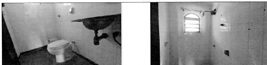
Fotos 10 e 11 – sanitário
