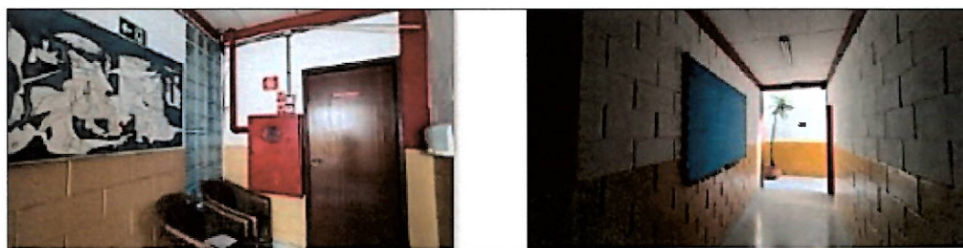
Fotos 44 e 45 – hidrante
