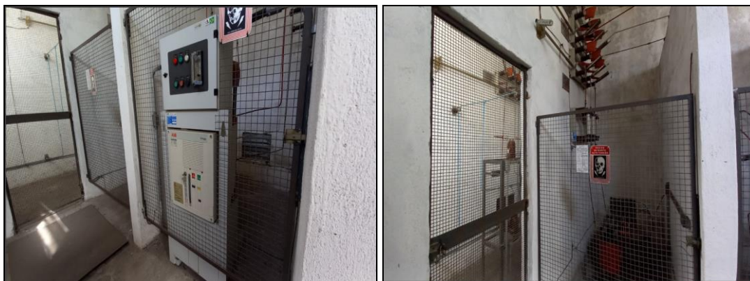
Fotos 60 e 61 – cabine primária
