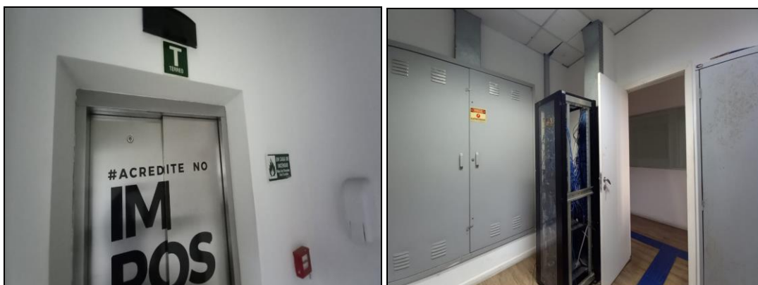
Fotos 22 e 23 – elevador no térreo/quadro de energia
