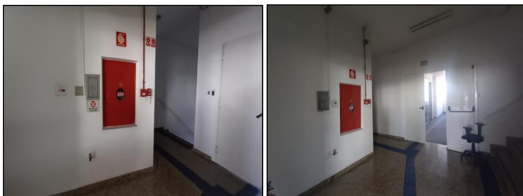
Fotos 20 e 21 – hidrante 1º andar
