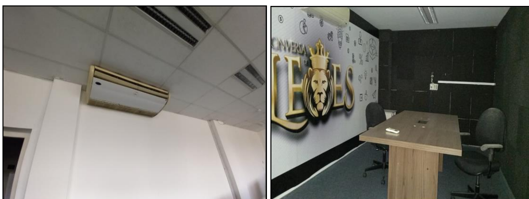
Fotos 10 e 11 – ar condicionado/ Studio
