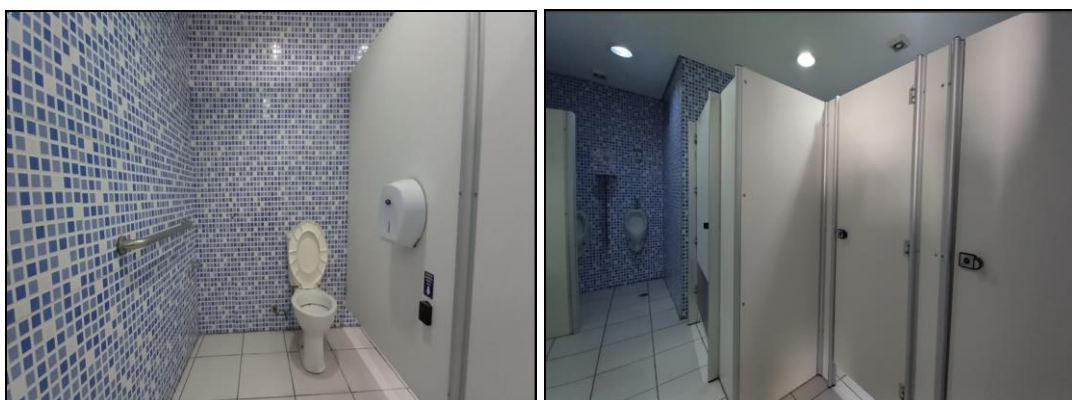
Fotos 08 e 09- banheiro do 1º andar
