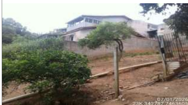
Foto: 1767795719598.jpg ID: 14 Formação de processo erosivo
