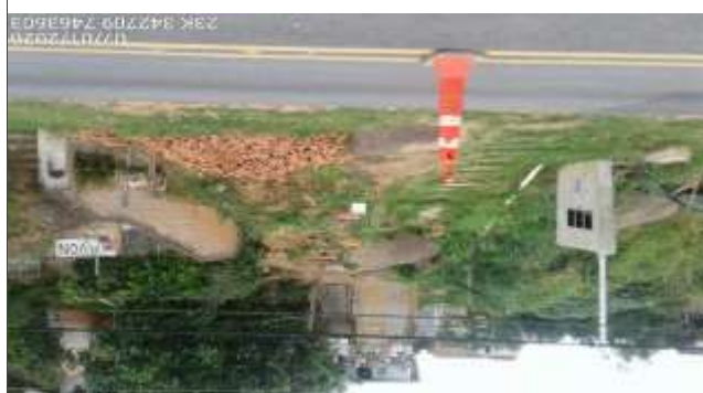
Foto: 1767795556465.jpg ID: 13 Formação de processo erosivo
