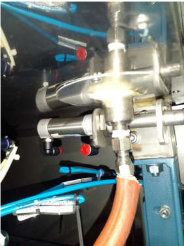
Desabilitado o cilindro pneumático da porta de carga
