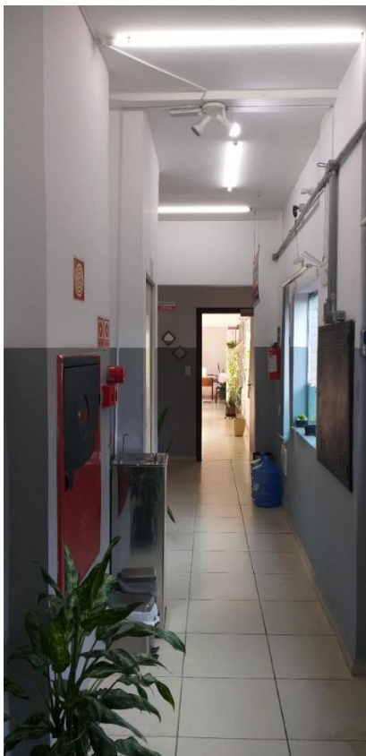
Fotos 13 – Vista do corredor com hidrante e extintor necessitando de troca;
