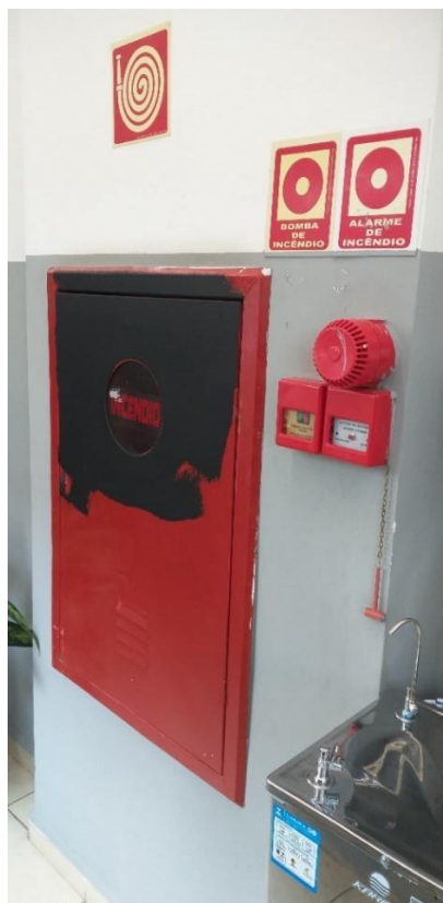
Fotos 12 – Vista do hidrante e sistema de alarme precisando de reparo e atualização;
