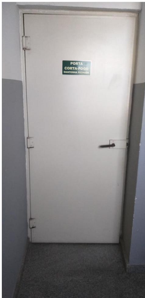
Fotos 05 – Vista da porta “corta fogo” de acesso aos pavimentos;
