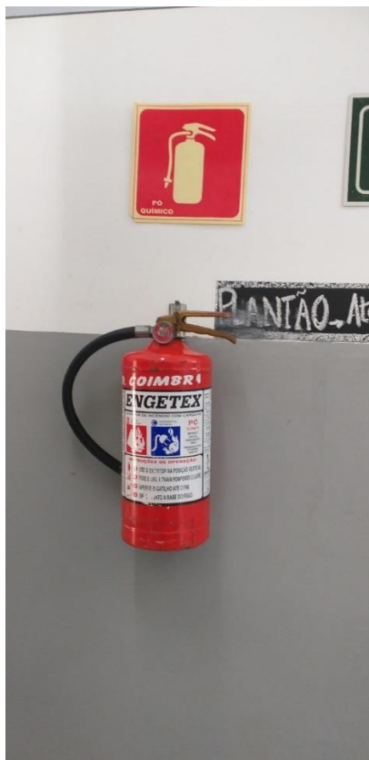
Fotos 11 – Vista do extintor a ser substituído;
