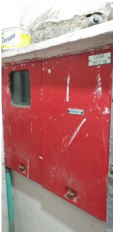
Fotos 15 – Vista do quadro de comando a ser atualizado;
