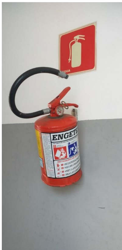
Fotos 10 – Vista do extintor a ser substituído;
