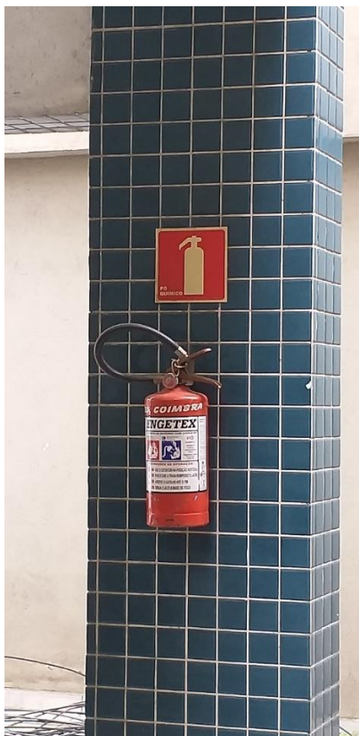
Fotos 14 – Vista do extintor do pavimento térreo a ser substituído;
