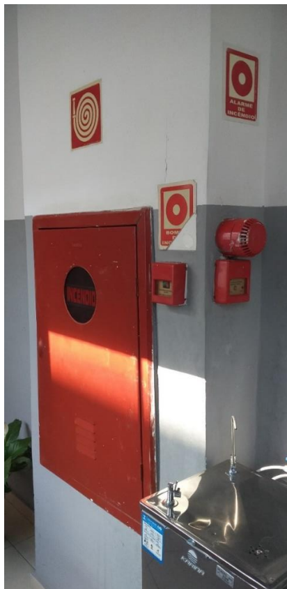
Fotos 09 – Vista do hidrante e sistema de alarme precisando de reparo e atualização;
