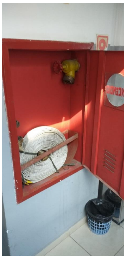
Fotos 08 – Vista do hidrante necessitando de reparo;
