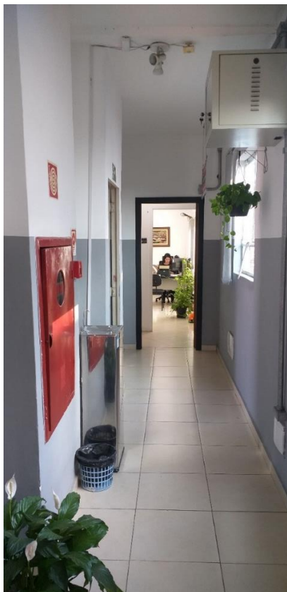
Fotos 07 – Vista do corredor com hidrante com localização do hidrante;
