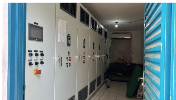
Foto 5 - Novos painéis elétricos da elevatória.
