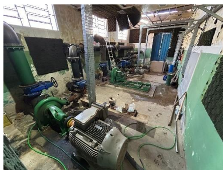
Foto 6 - Conjuntos motobomba da EEAT Jd. Santa Rosa
