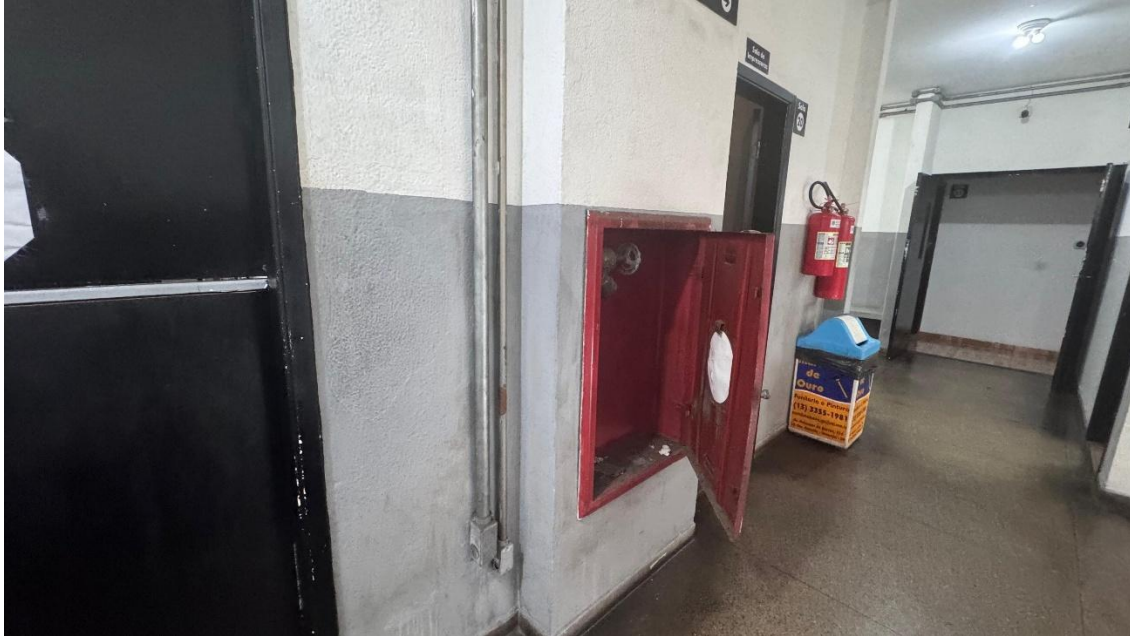
Foto 8 – Caixa de abrigo para mangueira contra incêndio sem mangueira.
