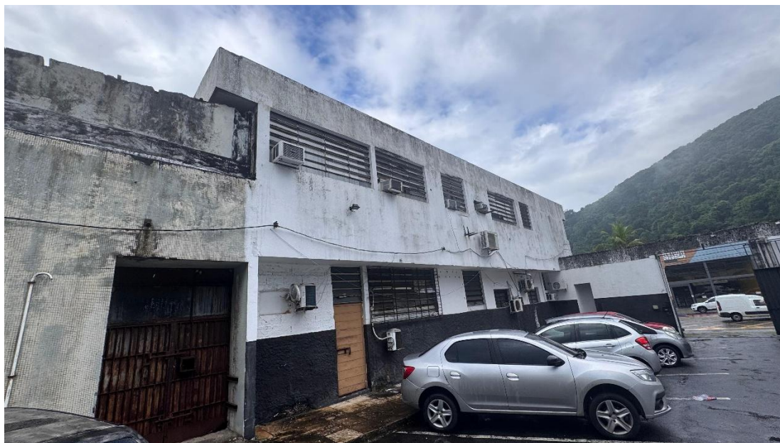
Foto 2 – Lateral do prédio onde mostra algumas adaptações elétricas.
