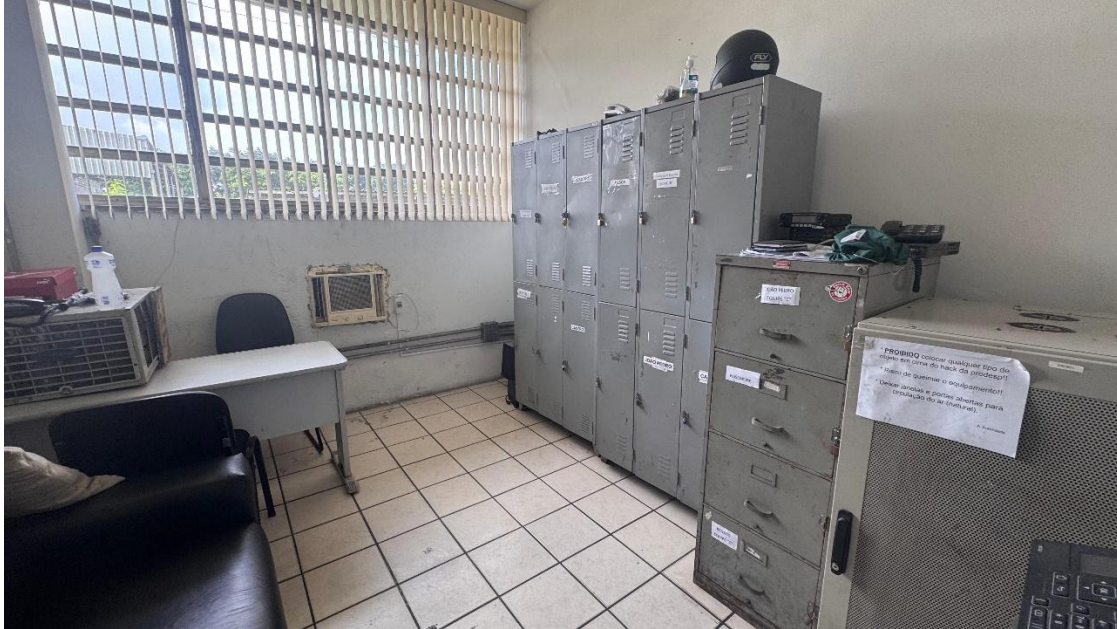
Foto 6 – Sala com instalação elétrica do ar-condicionado adaptada.
