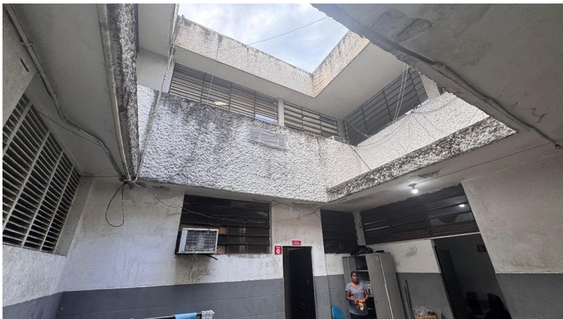
Foto 6 – Pátio interno com várias adaptações elétricas.
