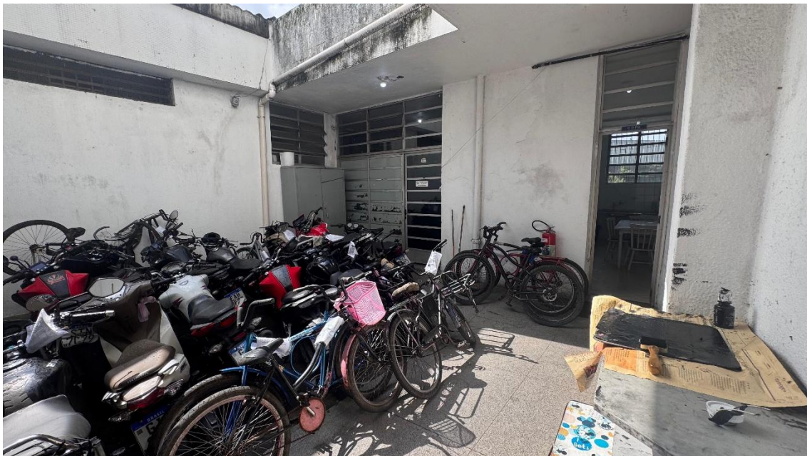
Foto 5 – Pátio interno o qual abriga alguns objetos, motocicletas apreendidas e um extintor obstruído.
