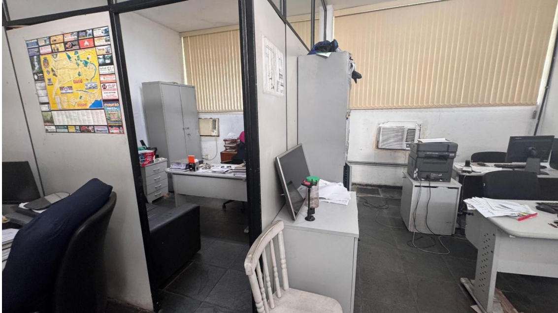
Foto 9 – Salas com instalações elétricas do ar-condicionado adaptadas.
