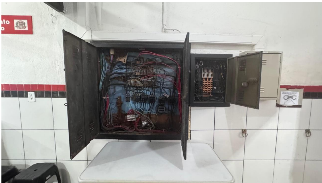
Foto 5 – Caixa de entrada de energia em desacordo com as normas técnicas vigentes.
