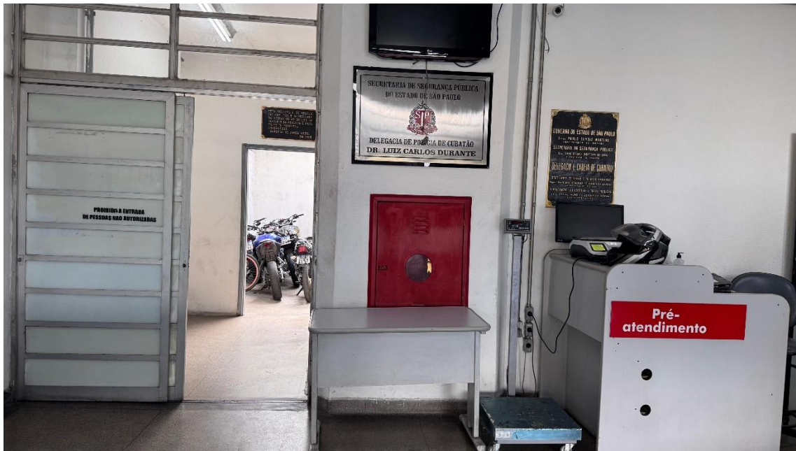
Foto 2 – Caixa de abrigo para mangueira contra incêndio obstruída e sem mangueira.
