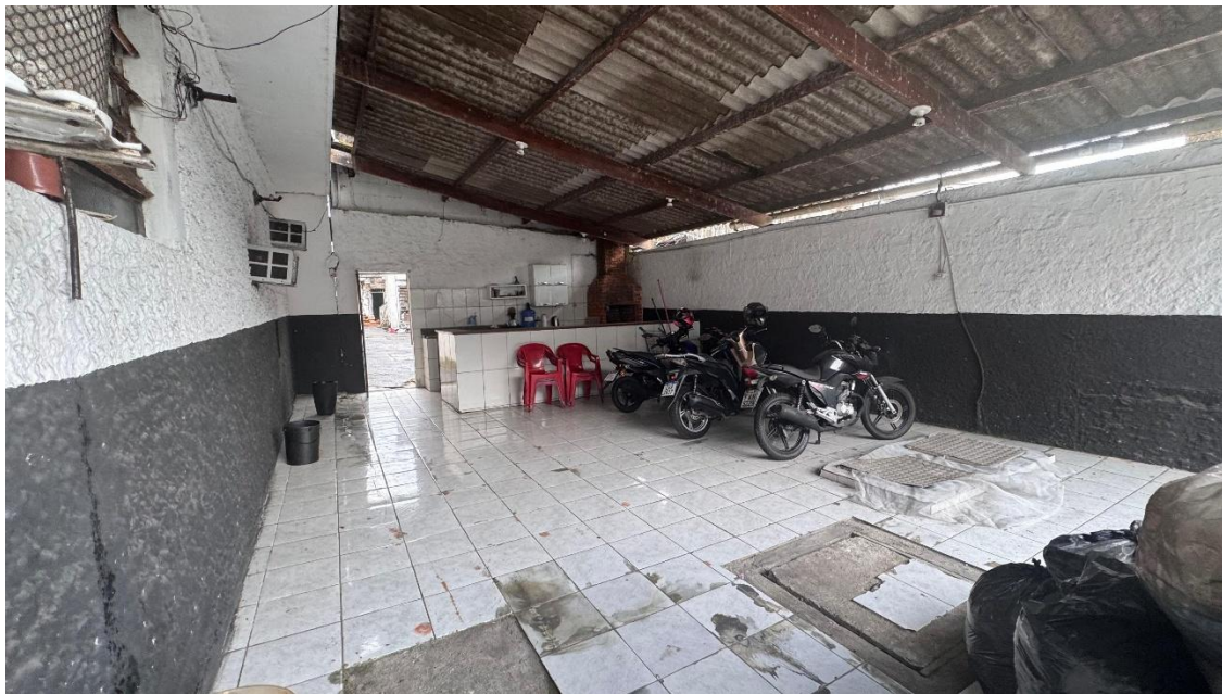
Foto 4 – Lateral direita do prédio com adaptações na rede elétrica.
