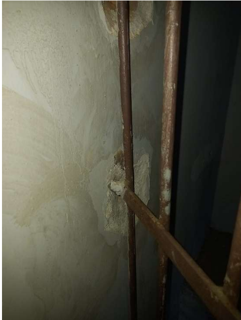
(Imagem 2) Locais de instalação na parede danificados
