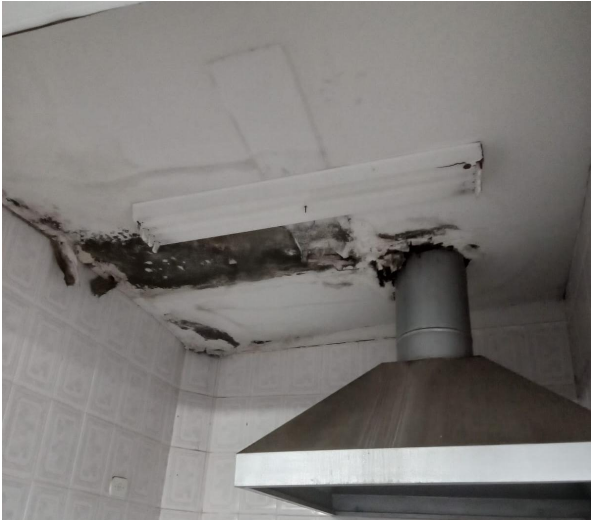
Foto nº 07 – Ponto de infiltração no telhado, causando danos ao forro de gesso e comprometendo o sistema de iluminação do ambiente.
