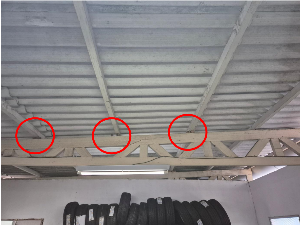
Foto nº 06 – Calços de madeira instalados com a finalidade de ajustar a inclinação do telhado, empregados em manutenção realizada posterior à construção original da cobertura.
