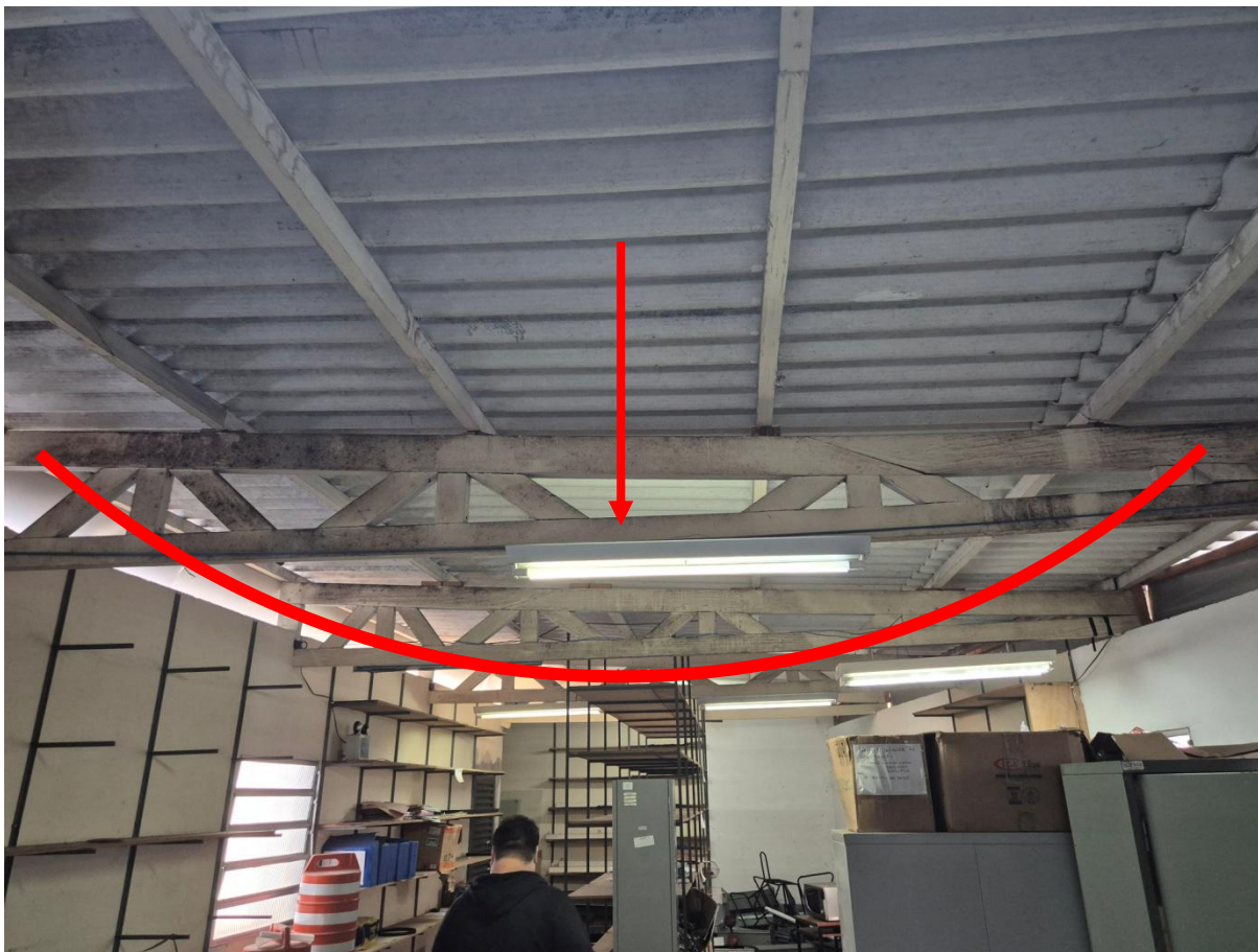
Foto nº 05 – Estrutura de madeira de sustentação da cobertura, evidenciando uma flecha por envergadura/arqueamento, instalada com inclinação inadequada para escoamento da água de chuva.
