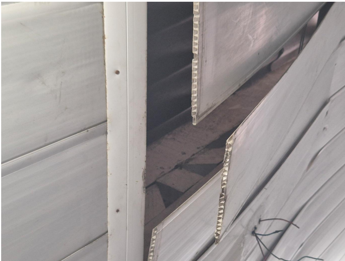
Foto nº 04 – Forro de PVC localizado abaixo da cobertura, em estado precário de conservação, apresentando desmontagem parcial e risco de queda.
