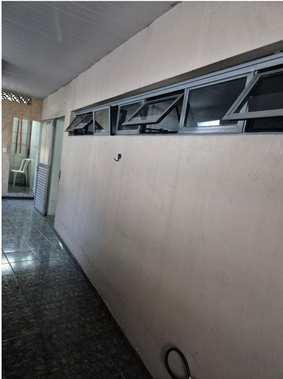
Foto nº 03 – Vista de ambiente localizado abaixo da cobertura, evidenciando marcas de escorrimento de água pela parede, indicativas de infiltração proveniente do telhado.
