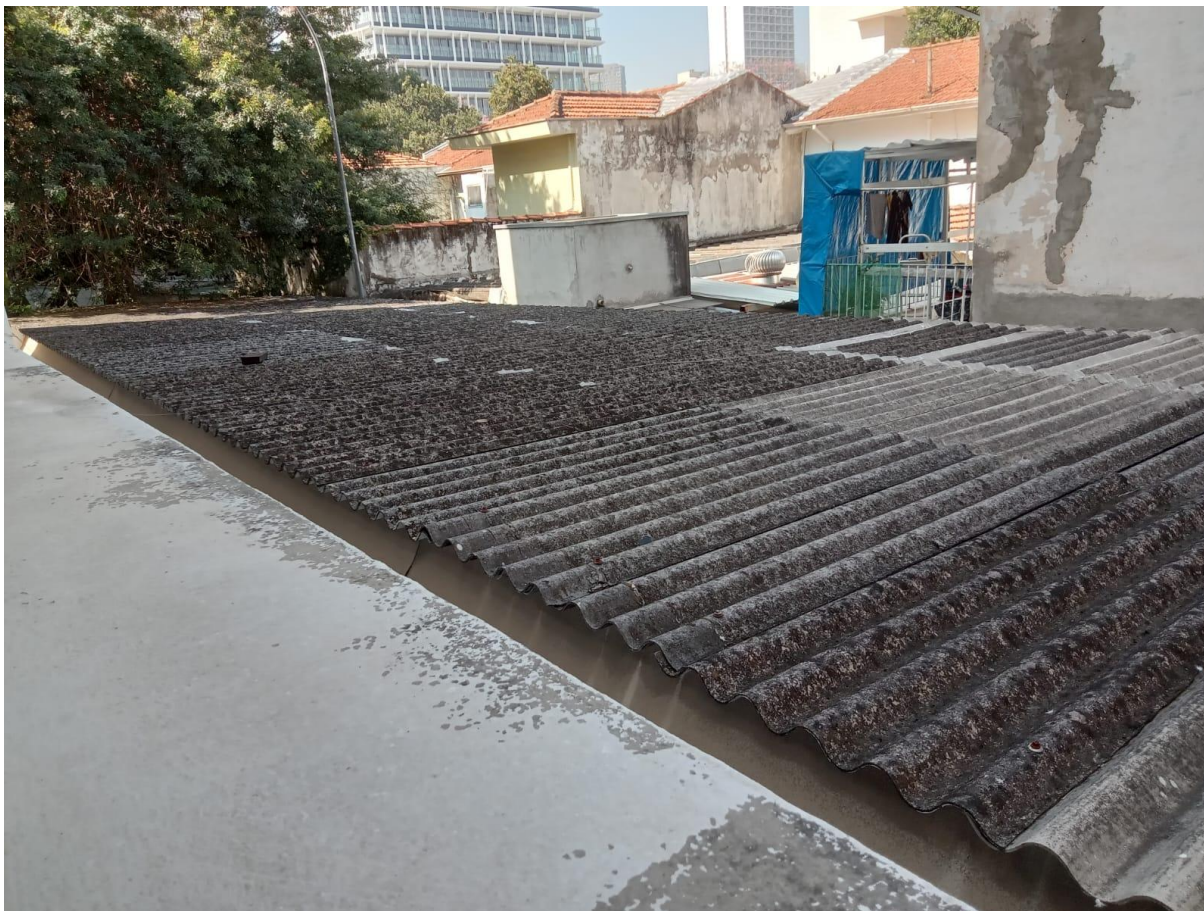
Foto nº 02 – Vista superior do telhado, cuja inclinação é insuficiente para o adequado escoamento da água da chuva, em desacordo com os parâmetros estabelecidos pela NBR 7196.
