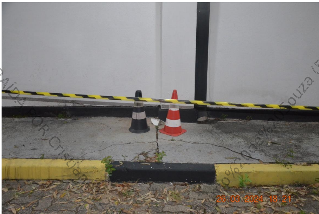
Imagem 3: Fragmento de concreto encontrado
