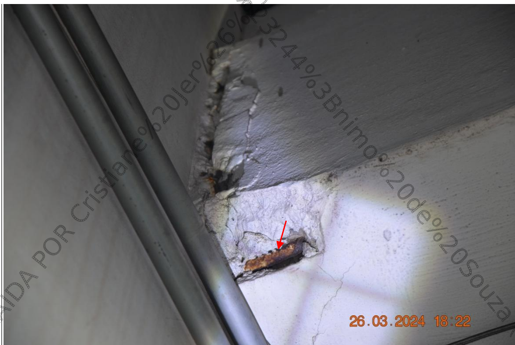
Imagem 6: Viga de sustentação (detalhe: armadura oxidada)
