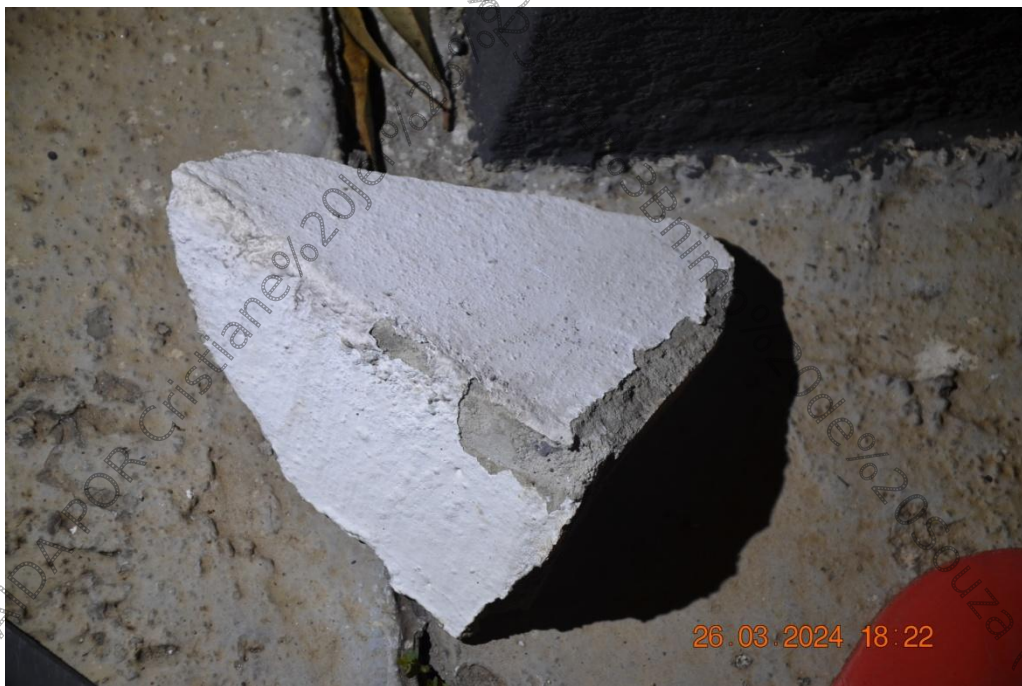
Imagem 4: Fragmento de concreto encontrado
