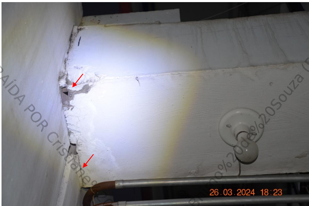
Imagem 7: Trincas e fissuras
