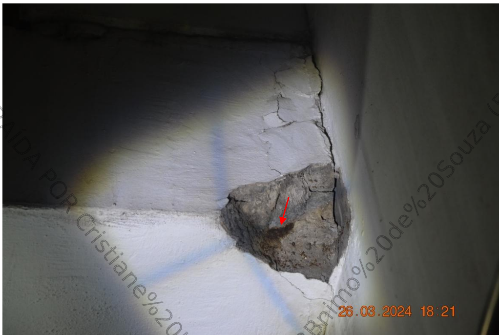
Imagem 5: Região compatível com o desprendimento (detalhe: armadura oxidada)
