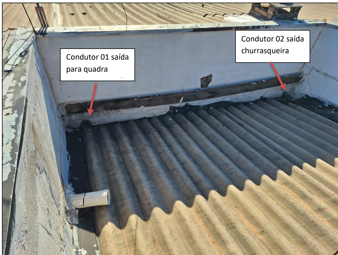
Figura 10: Telhado do P/2, a calha não suporta o volume de água e transborda. Não a espaço entre o telhado e o forro para a instalação de uma calha cocho. Solução inversão de parte final do telhado.
