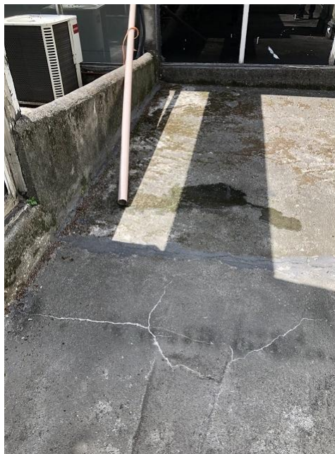
Foto número 07 – Trincas na laje de cobertura
