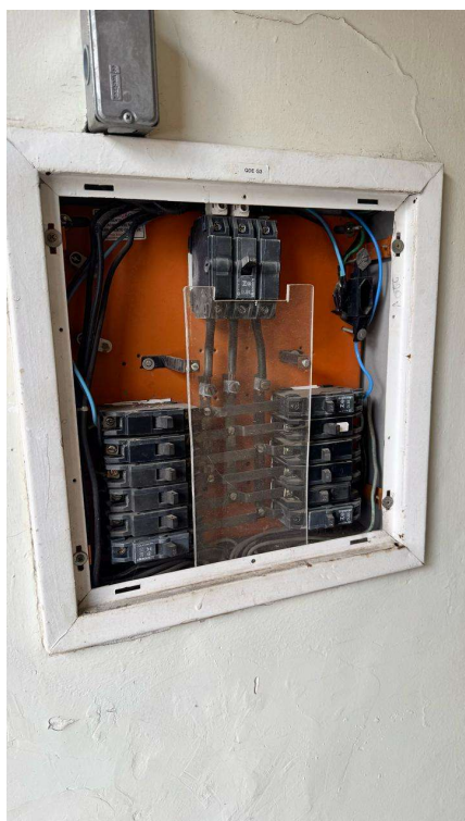
Figura 4 - Quadro de disjuntor - Depósito terceirizados lado esquerdo
