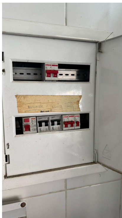
Figura 1 - Quadro de disjuntor – Cozinha
