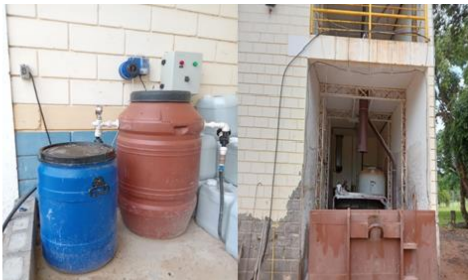
Figura 1: Sistema de Preparo, diluição e Dosagem Figura 2: Aspersores (bicos) para nebulização
