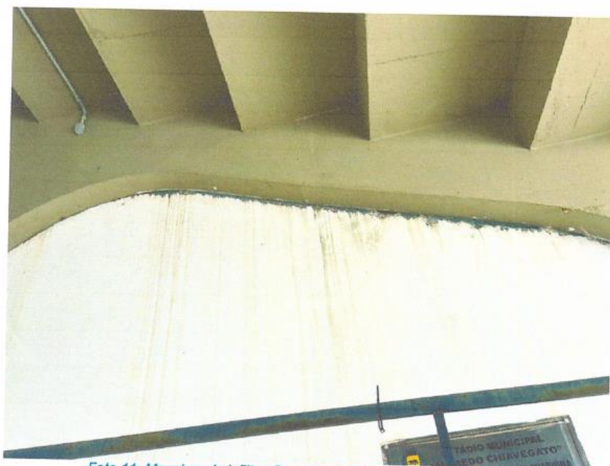
Foto 11: Manchas de infiltração no topo da parede. Falha de Grau R
