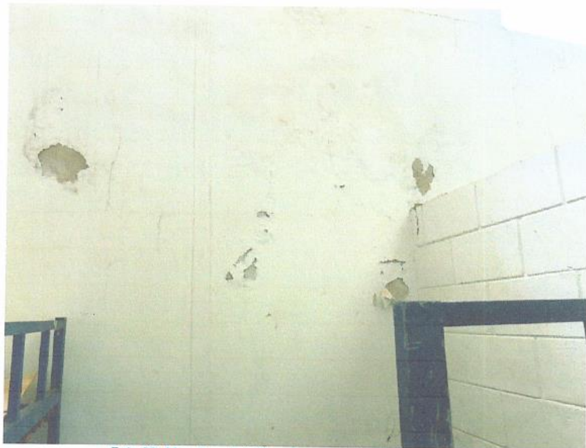
Foto 20: Manchas de infiltração na parede. Falha de Grau R
