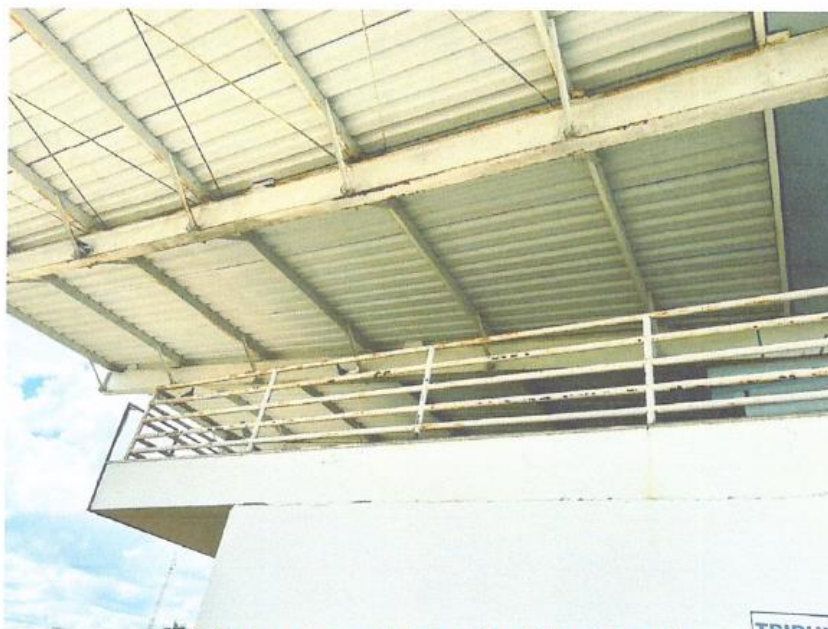
Foto 25: Ferrugem na estrutura metálica. Falha de Grau R
