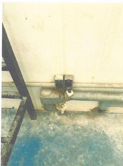
Foto 19: Tomada sem proteção. Falha de Grau R
