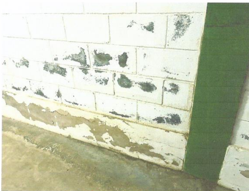
Foto 18: Pintura danificada. Falha de Grau R
