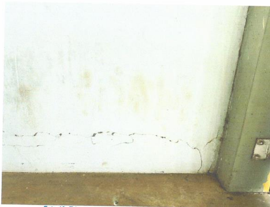
Foto 10: Trincas na parte inferior da parede. Anomalia de Grau R
