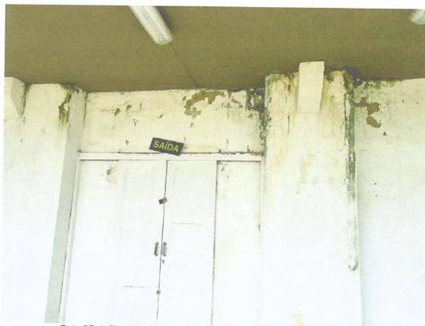
Foto 27: Infiltração de água passando pela laje. Anomalia de Grau R
