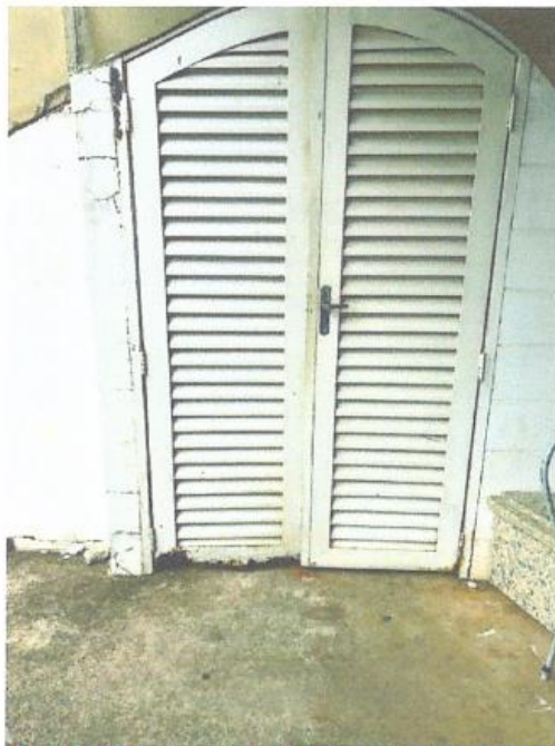
Foto 12: Porta de metal enferrujada. Falha de Grau R
