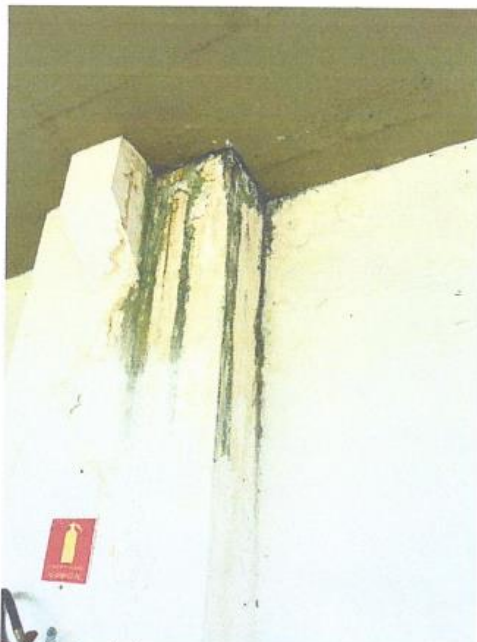
Foto 26: Infiltração de água entre a laje e o pilar. Anomalia de Grau R
