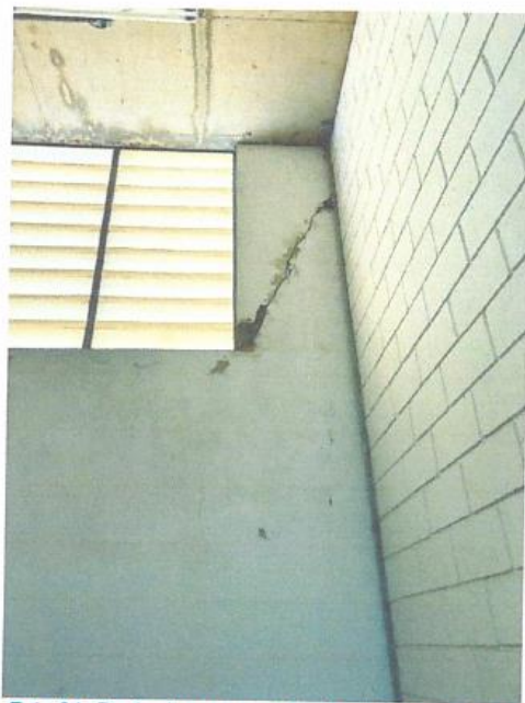
Foto 21: Rachadura na parede. Anomalia de Grau R
