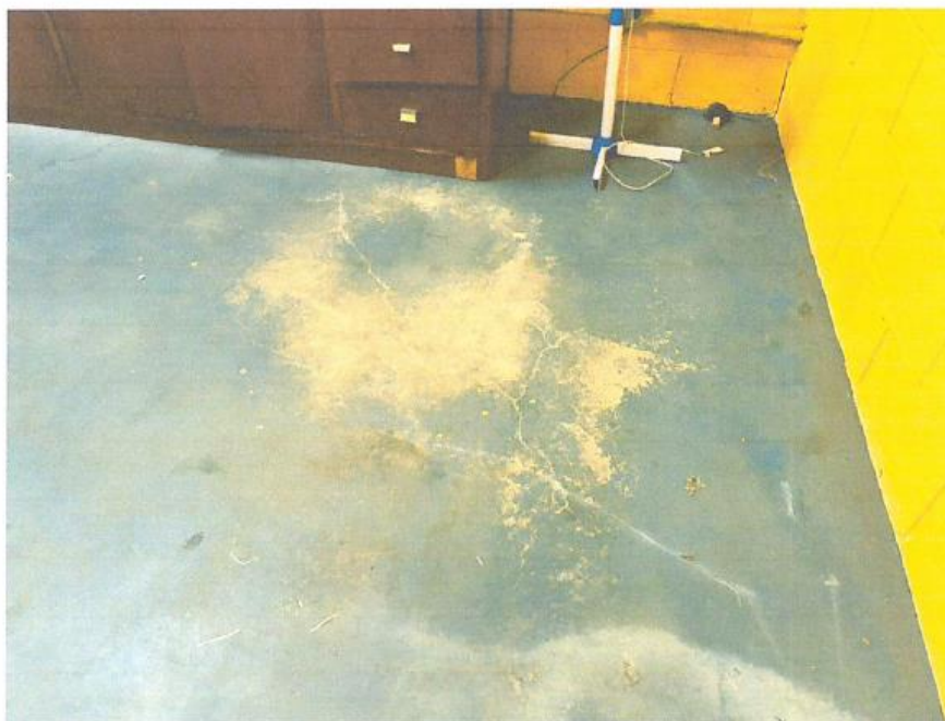
Foto 14: Pintura do piso danificada. Falha de Grau M
