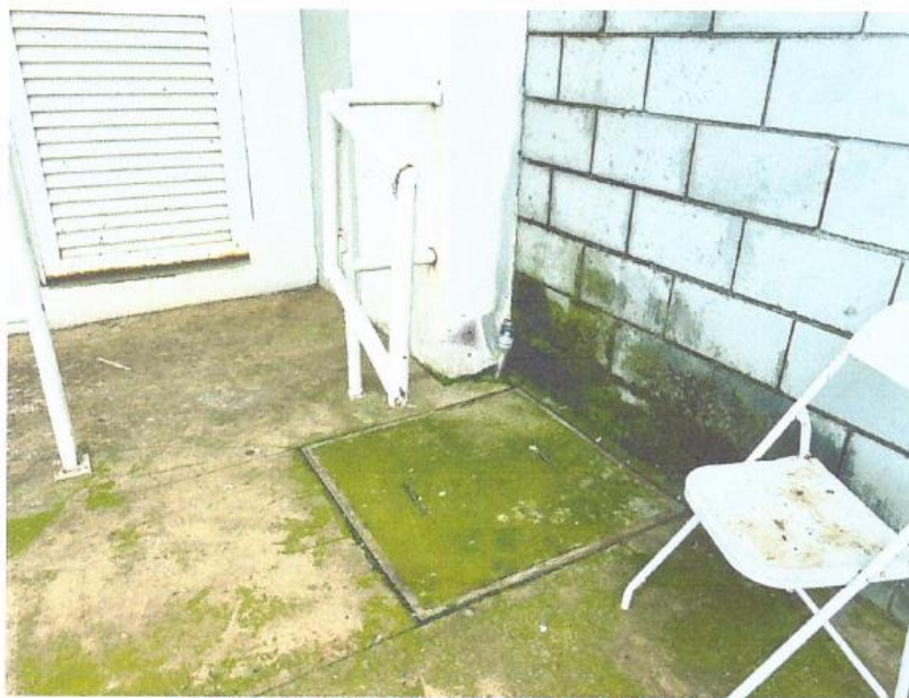
Foto 24: Lodo na parede devido a umidade. Falha de Grau R
