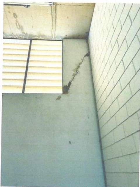
Foto 21: Rachadura na parede. Anomalia de Grau R
