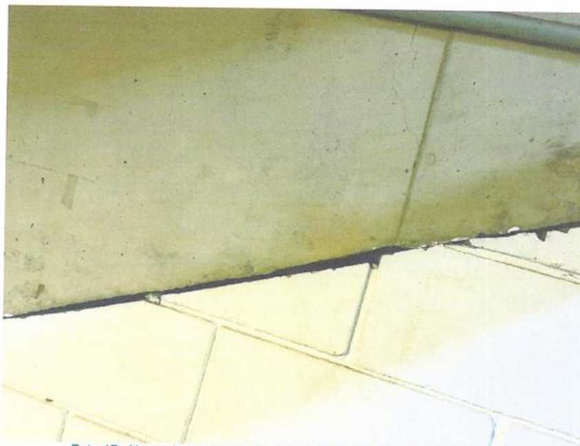
Foto 17: Alvenaria sem encunhamento com a viga. Anomalia de Grau M
