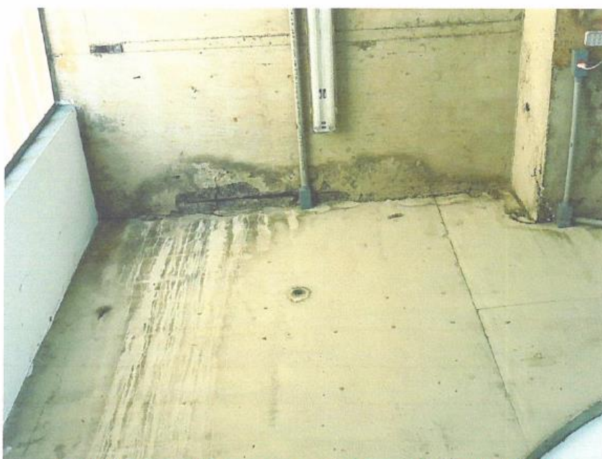
Foto 15: Deslocamento do concreto e armadura exposta. Anomalia de Grau R
