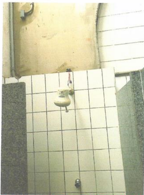
Foto 22: Fios de eletricidade sem proteção adequada. Falha de Grau R
