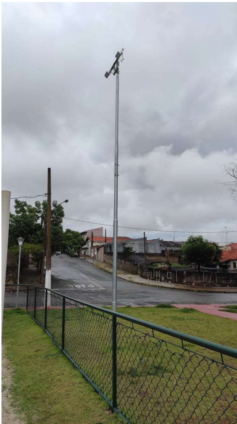
Imagem 04 – Poste com refletores
