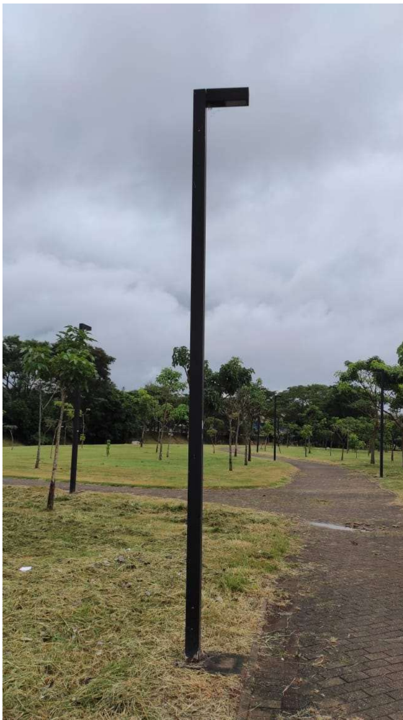
Imagem 03 – Poste de iluminação com perfil quadrado e luminária pétala incorporada
