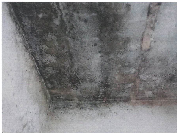
Figura 3 - Pontos de Infiltração e umidade na Unidade de Saúde Básica - UBS Vila Conde Siciliano. Fonte: Secretaria Municipal de Obras e Planejamento, 2024.
