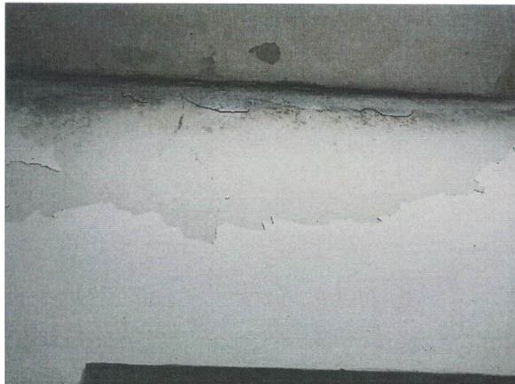
Figura 1 - Pontos de Infiltração e umidade na Unidade de Saúde Básica - UBS Vila Conde Siciliano. Fonte: Secretaria Municipal de Obras e Planejamento, 2024.
