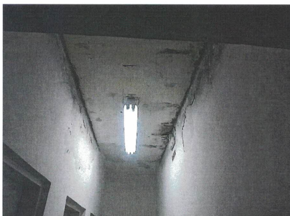
Figura 4 - Pontos de Infiltração e umidade na Unidade de Saúde Básica - UBS Vila Conde Siciliano. Fonte: Secretaria Municipal de Obras e Planejamento, 2024.
