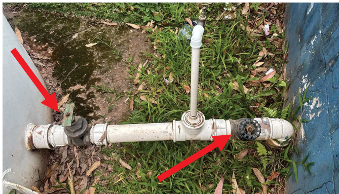
Figura 10 – O reservatório RS-01 é responsável pela alimentação da rede de distribuição de água da edificação. Durante a inspeção realizada, verificou-se que o abastecimento ocorre por gravidade, não sendo identificado qualquer sistema de recalque, pressurização ou bombeamento associado à distribuição de água a partir deste reservatório.
