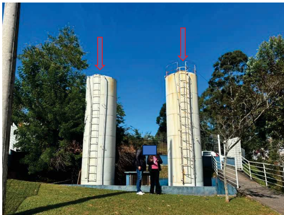
Figura 3 – A imagem apresenta os dois reservatórios que compõem o sistema de abastecimento da edificação. O reservatório localizado à esquerda é destinado exclusivamente à Reserva Técnica de Incêndio (RTI), responsável pelo atendimento ao Sistema de Combate a Incêndio, enquanto o reservatório localizado à direita destina-se ao abastecimento de água para consumo da edificação. Para fins de identificação e referência neste relatório, o Reservatório de Consumo será denominado RS-01 e o reservatório destinado à RTI será denominado RS-02.
