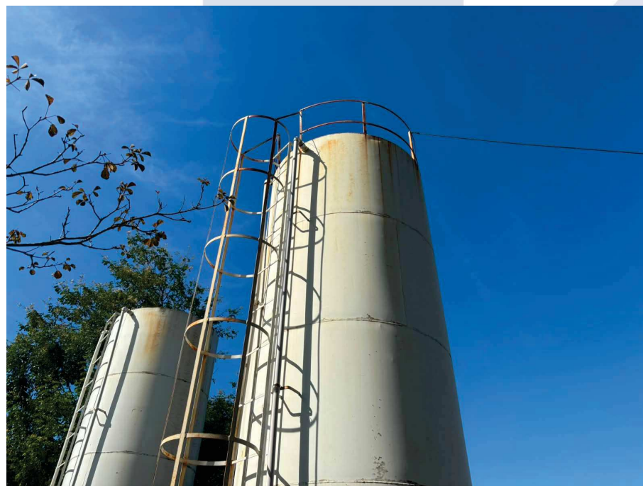
Figura 4 – Pontos de corrosão decorrentes da exposição contínua aos agentes atmosféricos, evidenciando a degradação do sistema de proteção superficial e contribuindo para a aceleração dos mecanismos de deterioração do material metálico.
