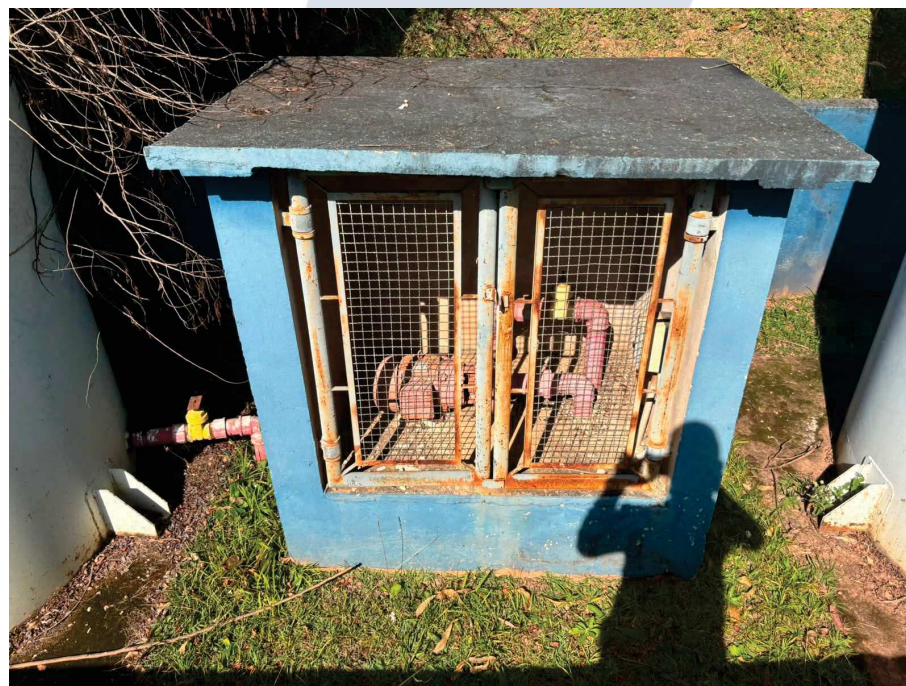
Figura 14 – Abrigo da bomba de recalque da Reserva Técnica de Incêndio (RTI). Observa-se a presença de pontos de corrosão na grade metálica de proteção do conjunto motobomba, evidenciando a degradação do sistema de proteção superficial em decorrência da exposição aos agentes atmosféricos. Recomenda-se a realização de tratamento anticorrosivo e repintura, visando preservar a integridade dos componentes e evitar a progressão do processo de deterioração.
