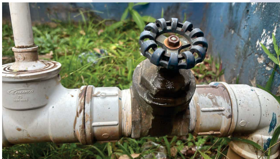
Figura 12 - O registro já apresenta vazamento visível, indicando perda de estanqueidade e comprometimento de suas condições operacionais.
