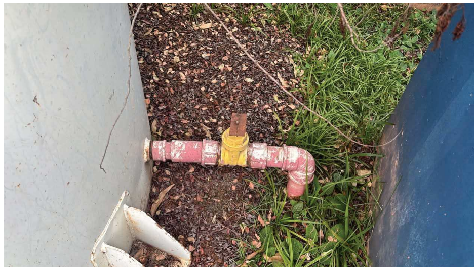
Figura 13 - Registro de gaveta de 2½" instalado no reservatório RS-02, destinado à Reserva Técnica de Incêndio (RTI), apresentando estado de conservação incompatível com a criticidade do sistema ao qual pertencem. Recomenda-se a substituição dos componentes, tendo em vista que sua deterioração pode comprometer a operação e a disponibilidade hídrica do sistema de hidrantes em caso de sinistro, afetando diretamente a segurança da edificação.
