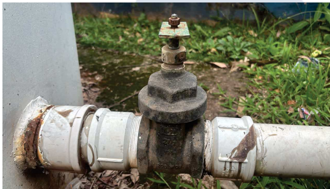
Figura 11 – Registros de gaveta de 2½" em latão bruto apresentando sinais de deterioração e comprometimento funcional. Recomenda-se sua substituição imediata, a fim de evitar falhas operacionais, vazamentos e prejuízos à operação do sistema de abastecimento de água.
