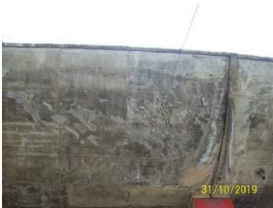
FOTO 126 Fissuras com eflorescência, com posicionamento diagonal e abertura máxima de 0,3mm na laje inferior LI, face Inferior, vão 4.
