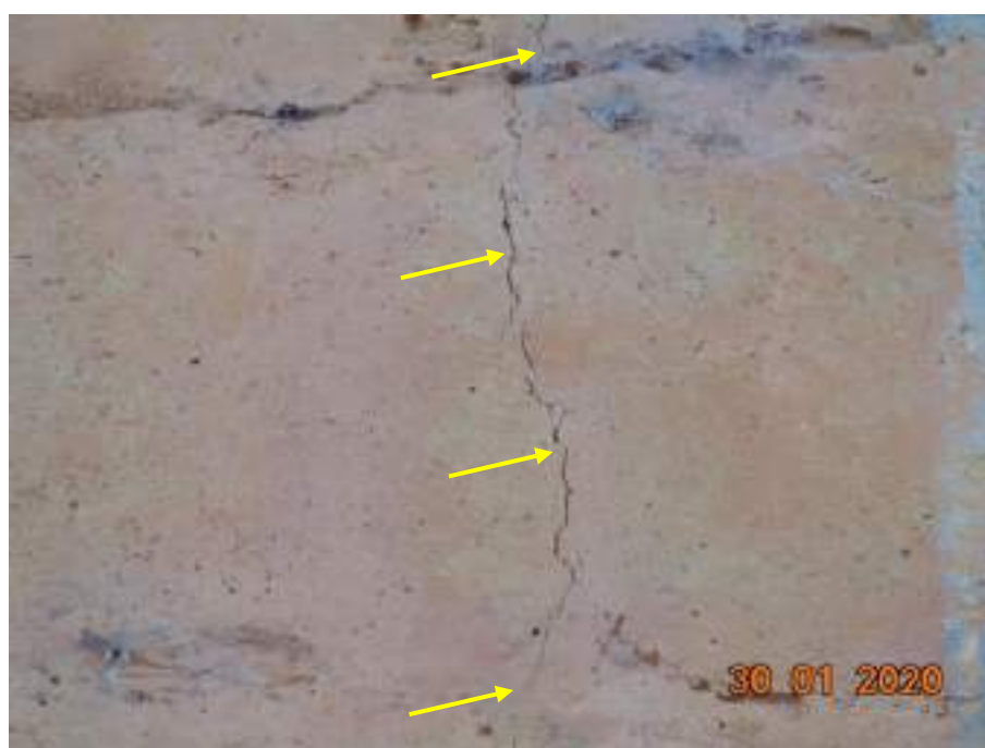
FOTO 188 Fissura com posicionamento vertical e abertura máxima de 0,5mm no pilar P5, face Norte.
