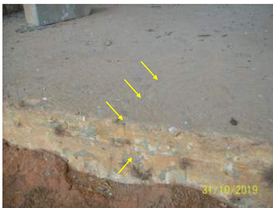
FOTO 218 Fissuras com posicionamento vertical ou transversal e abertura máxima de 0,2mm no bloco de fundação BLC2, apoio AP3, face Leste e Superior.
