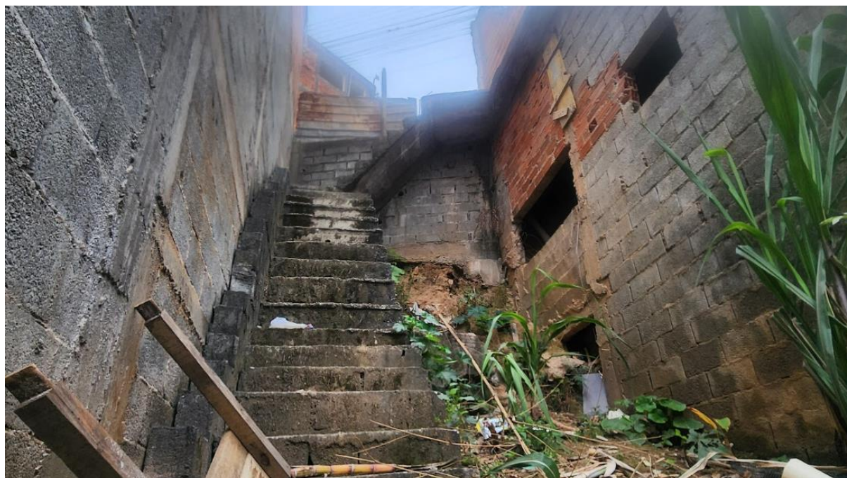
Foto 23: Tubulação em mau estado do poço de visita existente desaguando na viela de serviço
