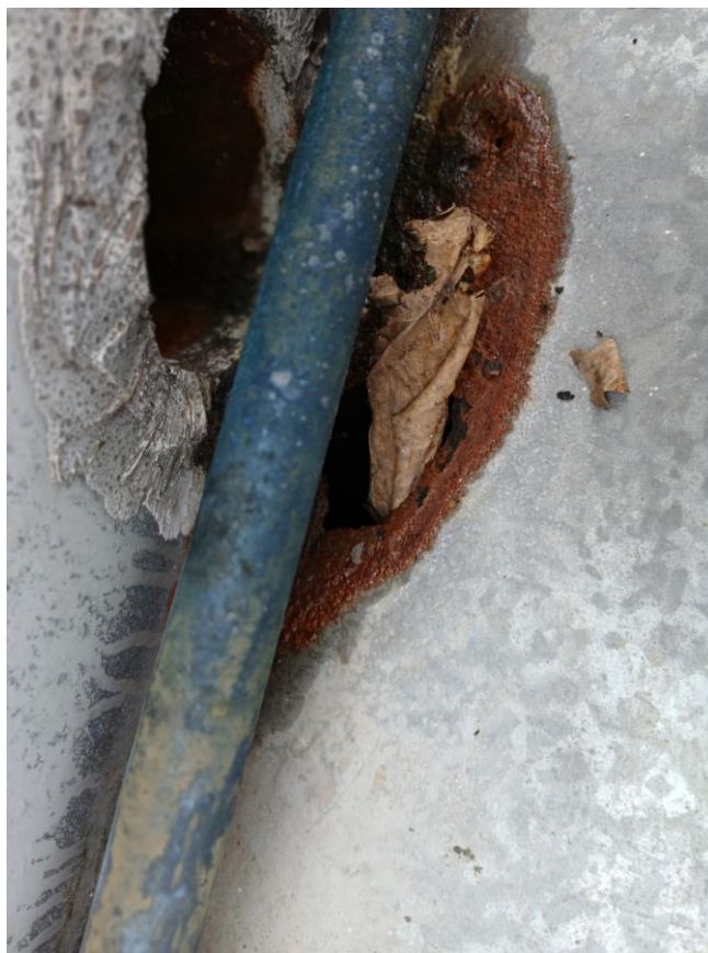
Figura 10 – Perfuração causada por corrosão.
