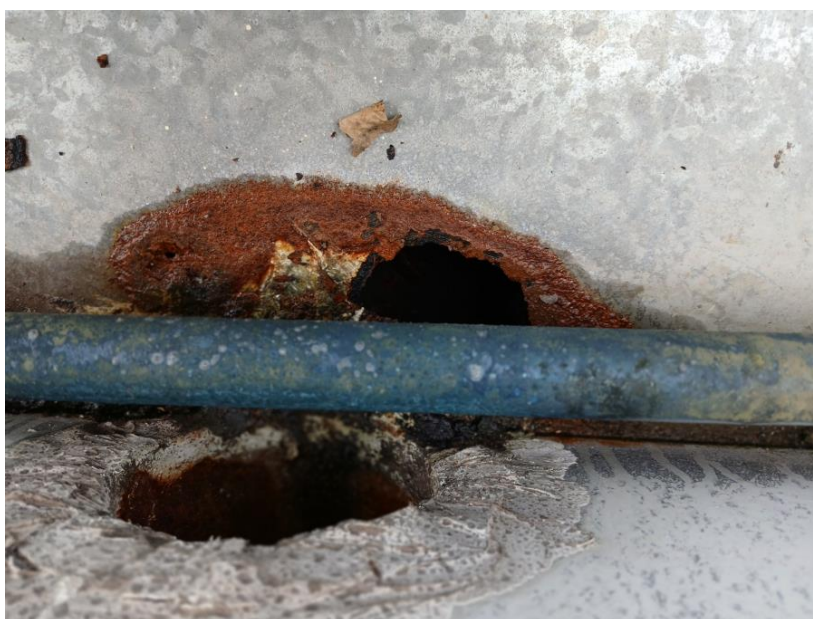
Figura 11 – Detalhe complementar da corrosão no sistema de drenagem.
