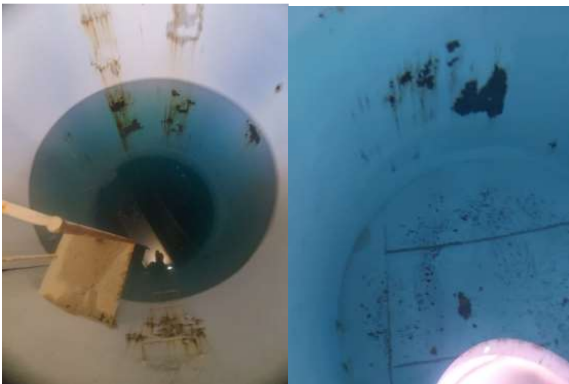
Reservatório de água metálico cilíndrico (interno) - 150m 3
