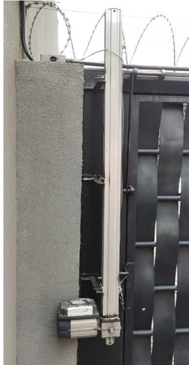
Figura 1 - Motor atualmente instalado no portão da garagem
