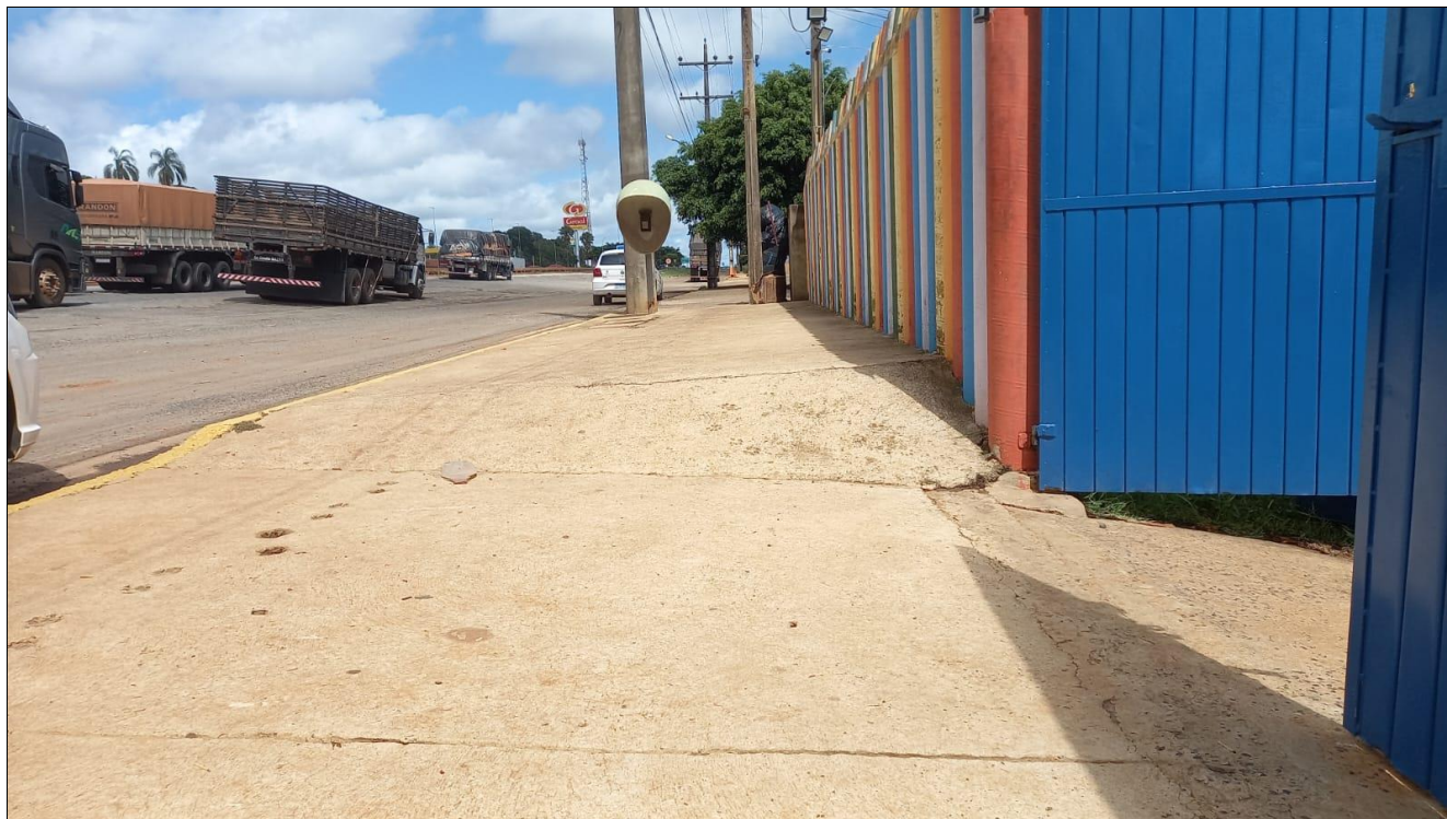
Foto 1: calçada a ser nivelada com inclinação à rua Miguel Amaro
