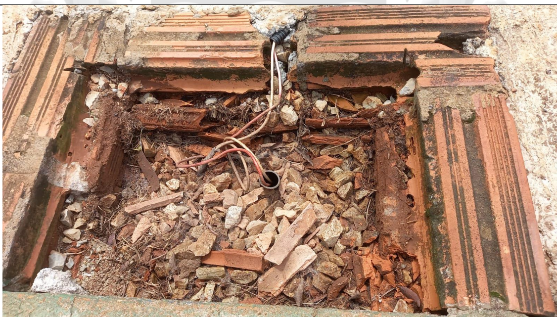
Foto 4: caixa de passagem de cabo elétrico expostos
