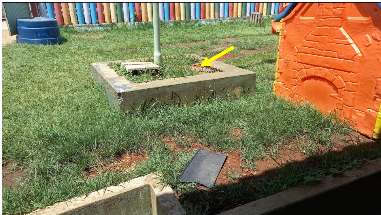
Foto 3: caixa de passagem de cabo elétrico sem tampa
