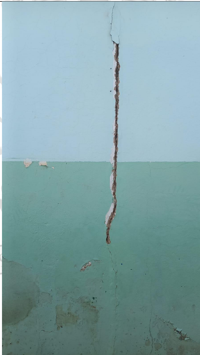
Foto 15: trinca na parede a ser reparada
