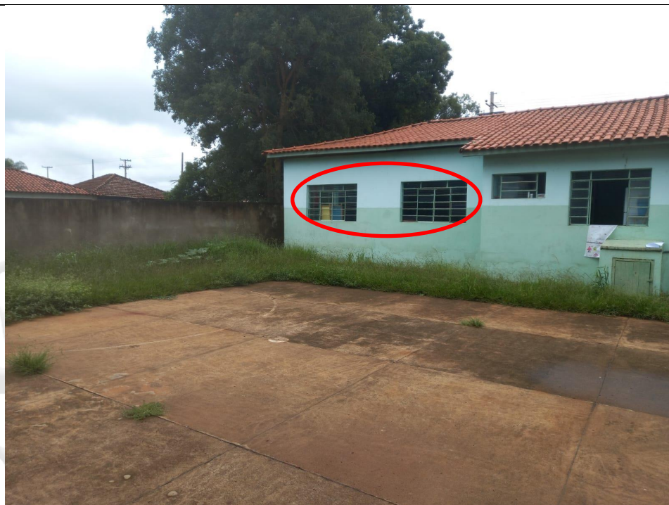
Foto 10: janelas da sala de aula 3
