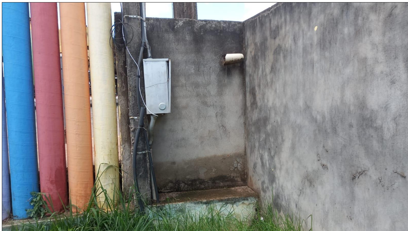
Foto 7: poste padrão de energia a ser fechado com gradil metálico
