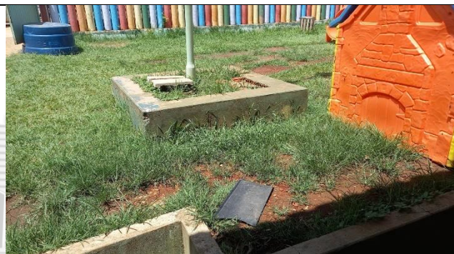
Foto 4: caixa inspeção elétrica
