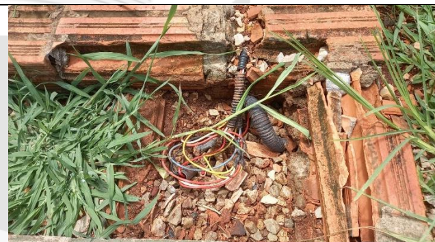
Foto 6: caixa inspeção precária (Foto 4)
