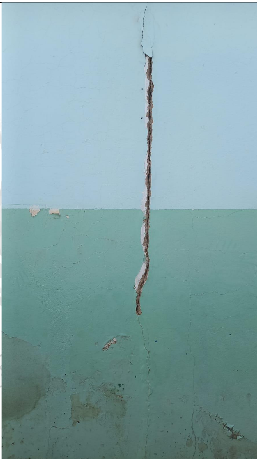
Foto 14: trinca na parede a ser reparada
