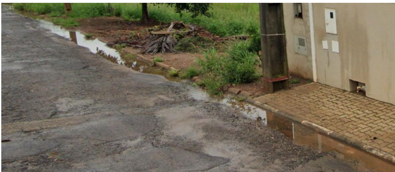
Foto dos danos causados pelas inundações na Rua das Calêndulas.
