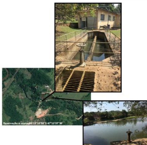
Fig. 04: Reserva e captação Ribeirão Piraí. (Prefeitura de Salto SP, 2024)
