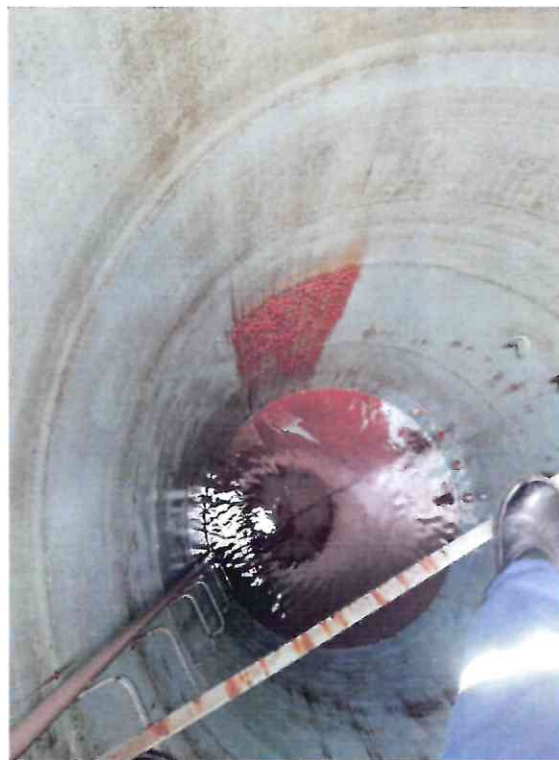
Figura 13 - Presença de corrosão e ferrugem na estrutura interna.
