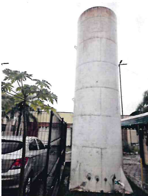
Figura 3 - Reservatório em estado crítico de conservação, com elevado grau de deterioração.
