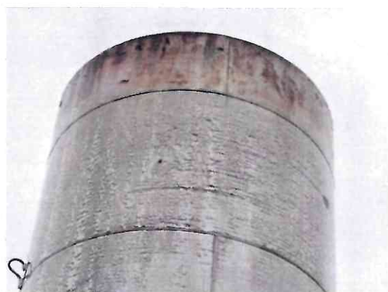
Figura 6 - Presença de corrosão e ferrugem na estrutura.
