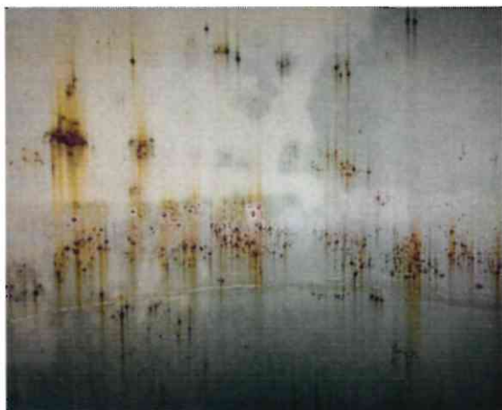
Figura 11 - Presença de corrosão e ferrugem na estrutura interna.
