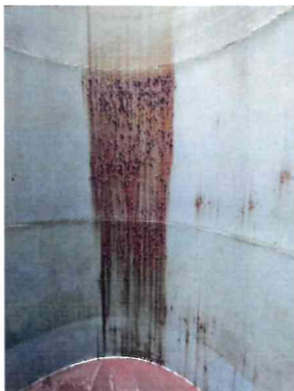
Figura 15 - Presença de corrosão e ferrugem na estrutura interna.
