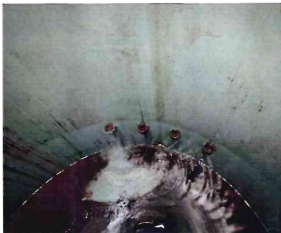
Figura 12 - Presença de corrosão e ferrugem na estrutura interna.
