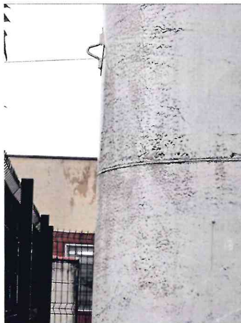
Figura 4 - Reservatório em estado crítico de conservação, com elevado grau de deterioração.
