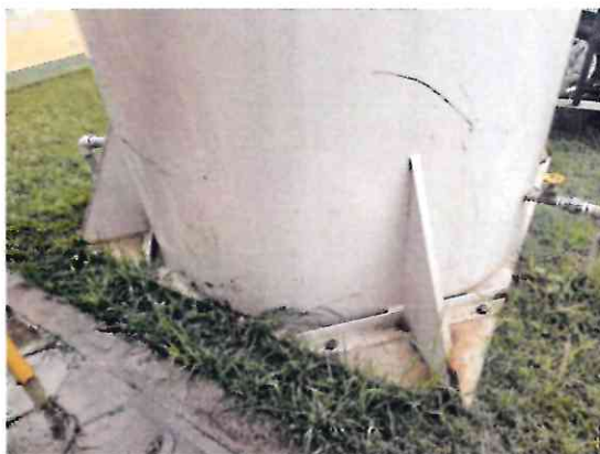
Figura 8 - Presença de corrosão e ferrugem na estrutura.
