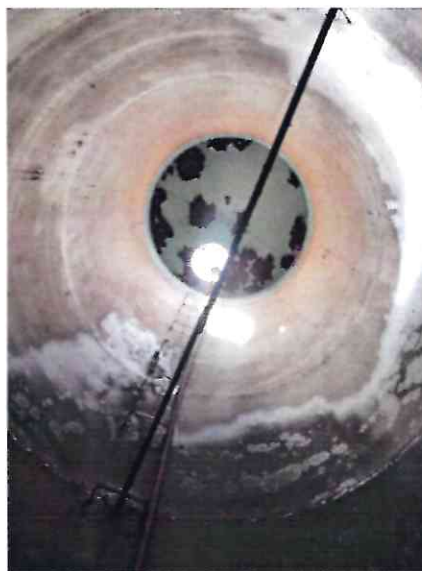
Figura 16 - Presença de corrosão e ferrugem na estrutura interna.
