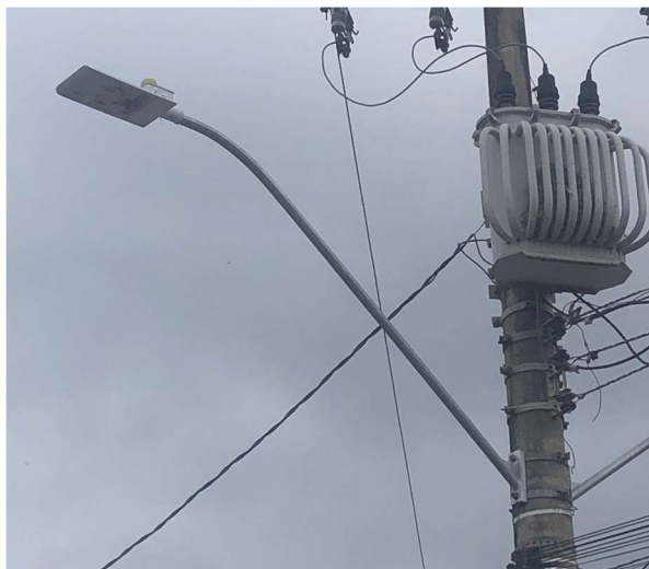
Imagem 04: Imagem ilustrativa da instalação completa
