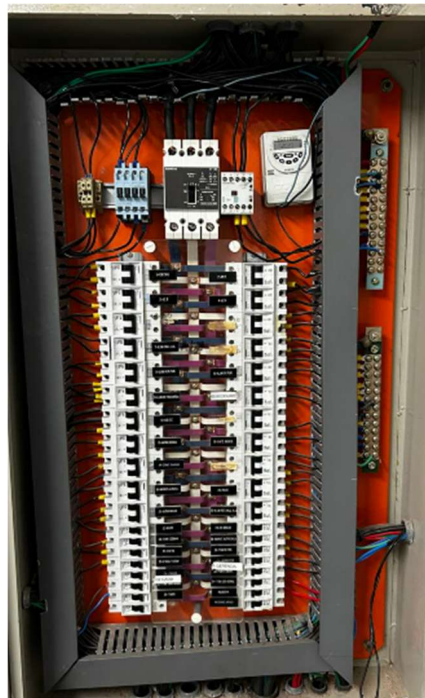
Quadro elétrico principal a ser adequado
