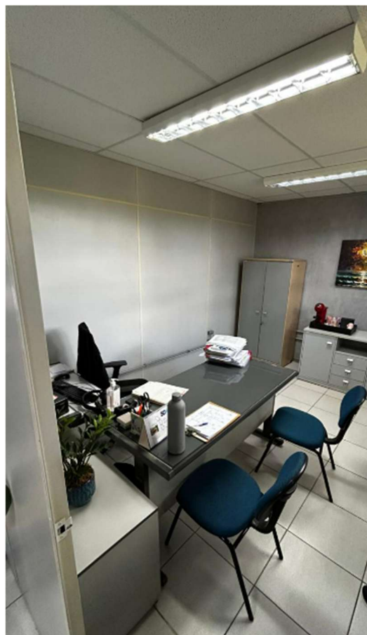
Divisórias e forro a serem adequados
