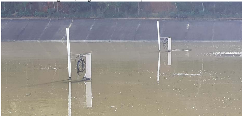
Figura 10. Lagoa de mistura completa com aeradores
