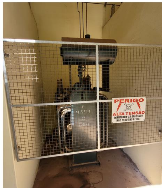
Transformador 01 – A ser substituído
