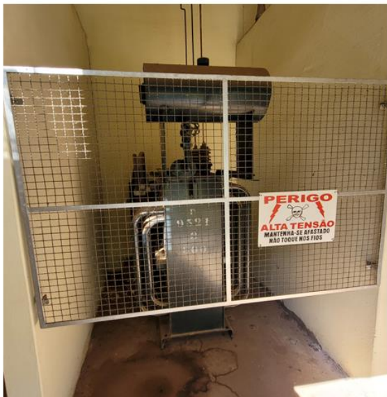
Transformador 02 – A ser substituído
