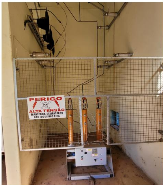
Disjuntor Beghim PL15C – A ser substituído
