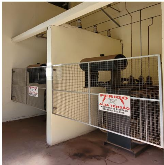
Transformadores a serem substituídos
