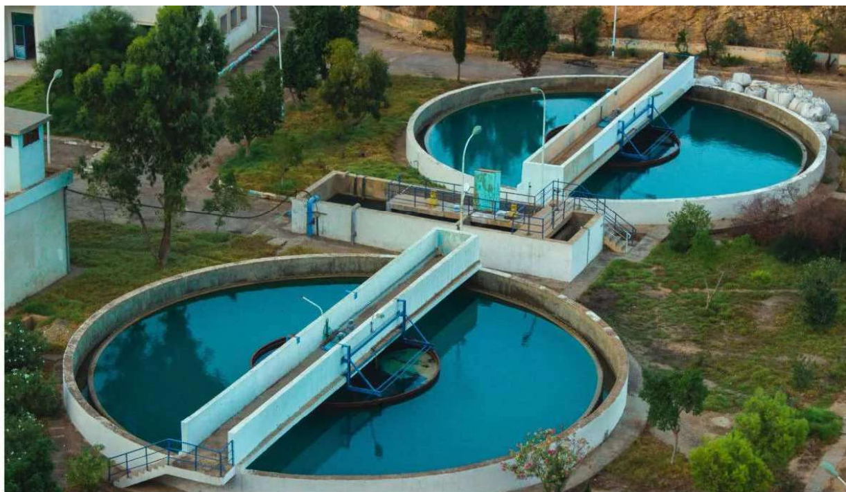
Estação de tratamento de água com fluoretação. | Crédito: Grupo Alquimia/Divulgação
