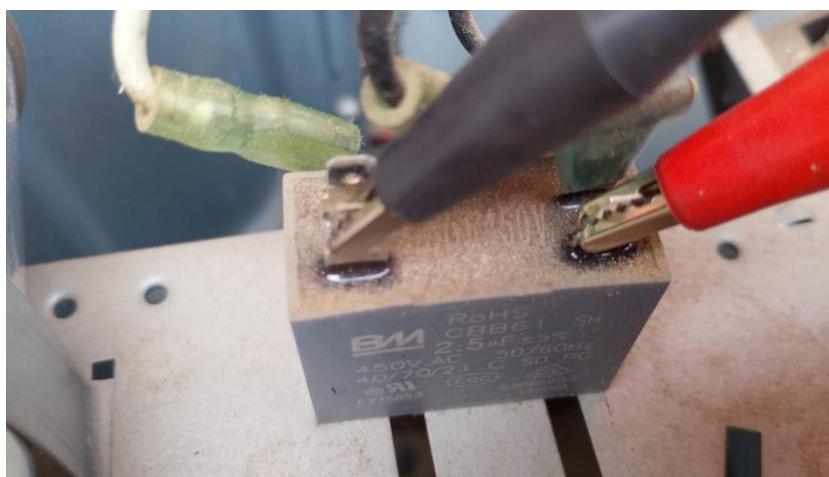
Imagem do capacitor de 2,5 uF da condensadora
