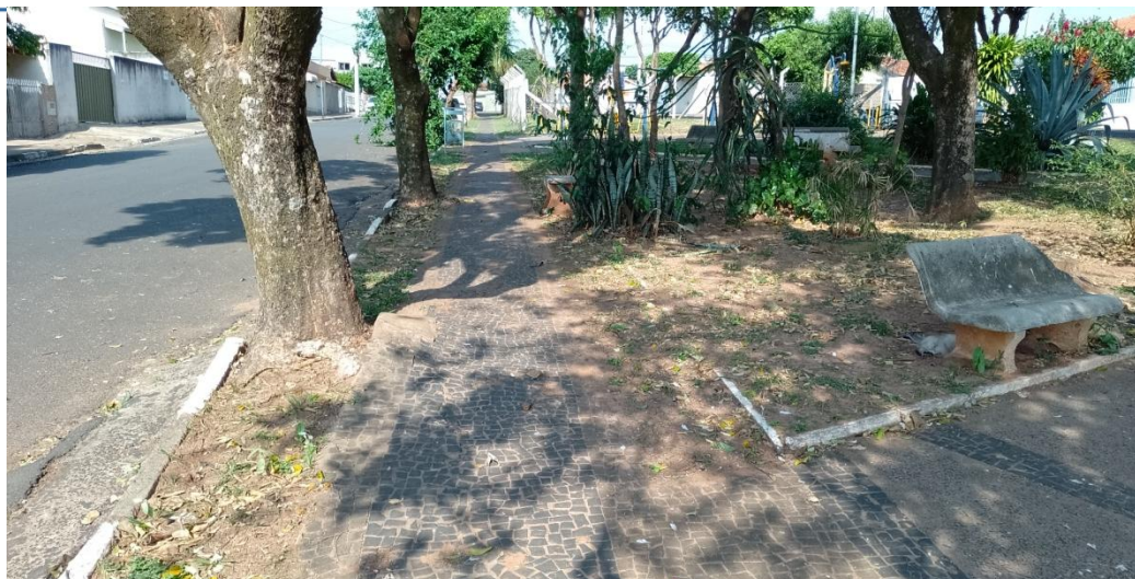
Figura 3 - Calçada a ser demolida e substituída por calçada em concreto.
