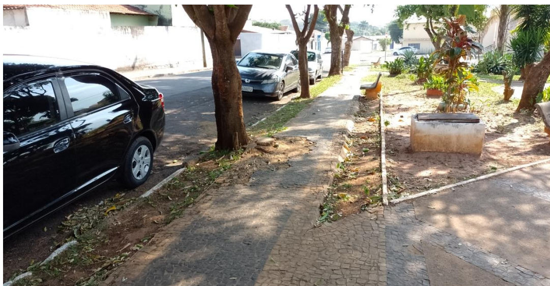
Figura 2 - Calçada a ser demolida e substituída por calçada em concreto.
