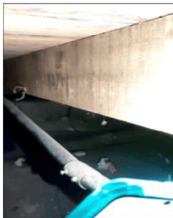
Figura 02 – Acúmulo de fungos e cupins, início de comprometimento
