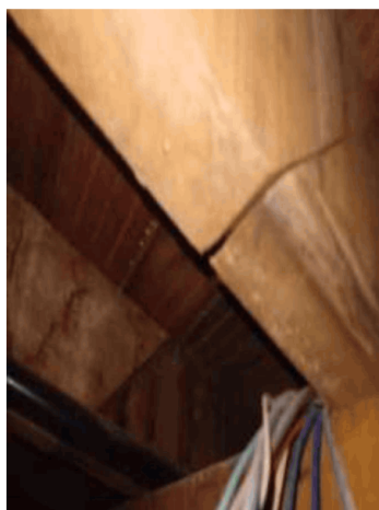
Figura 03 – Peças estruturais em estado de decomposição perdendo sua função estrutural, riscos elétricos
