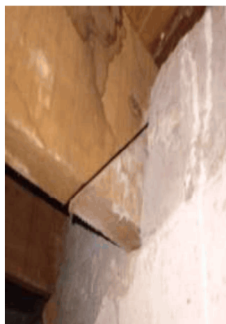
Figura 04 – Peças de apoio e de estrutura com acúmulo de umidade e fungos
