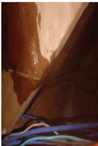
Figura 10 – Riscos de curto circuito
