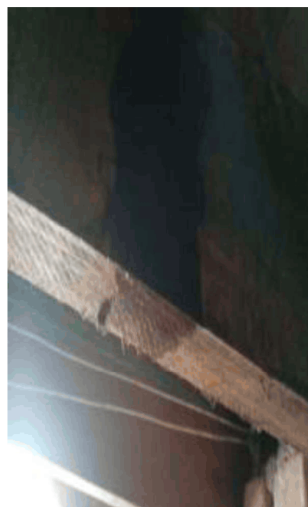
Figura 11 – Riscos de curto circuito
