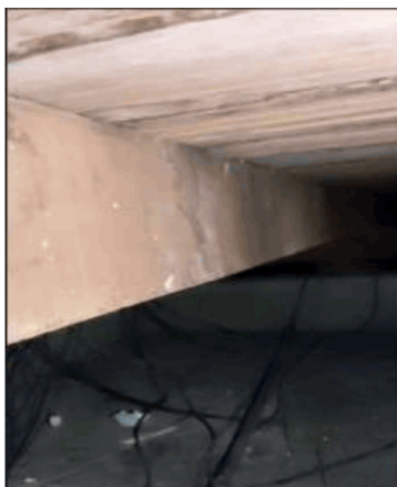
Figura 01 – Viga em flambagem devido a alta carga existente
