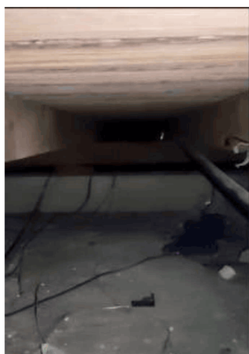
Figura 05 – Piso do mezanino em deformação devido ao arranjo estrutural estar perdendo a sua eficiência
