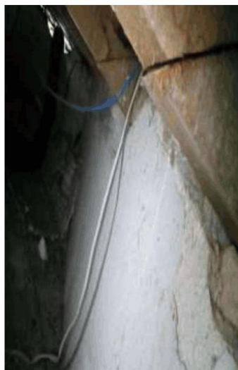
Figura 06 – Deslocamento de viga
