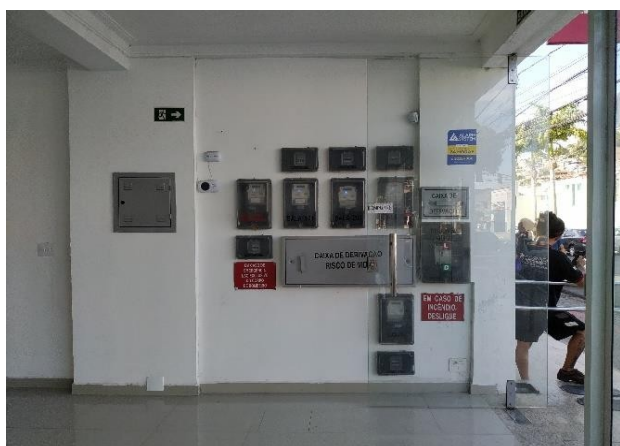
FOTO 05: Padrão de energia situado no salão I Térreo
