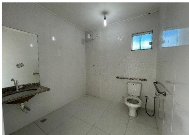
FOTO 11: Banheiro adaptado para PcD
