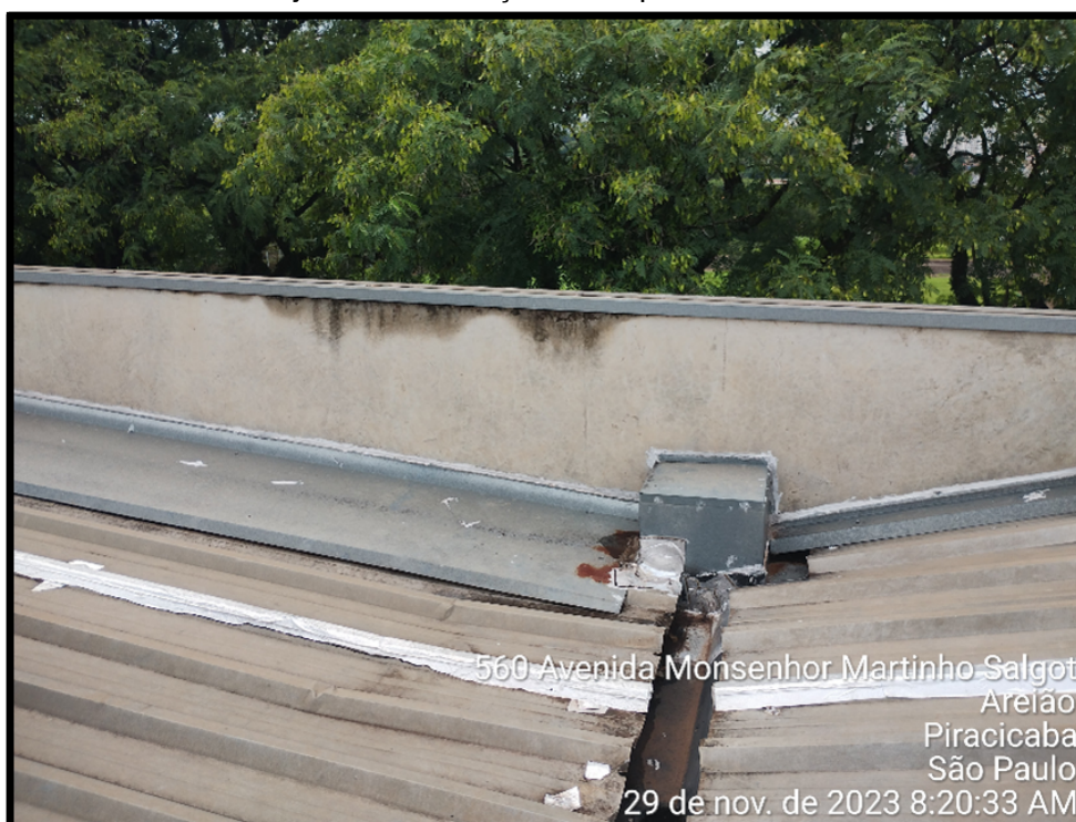
Vista dos rufos com vazamento e o transpasse incorreto
