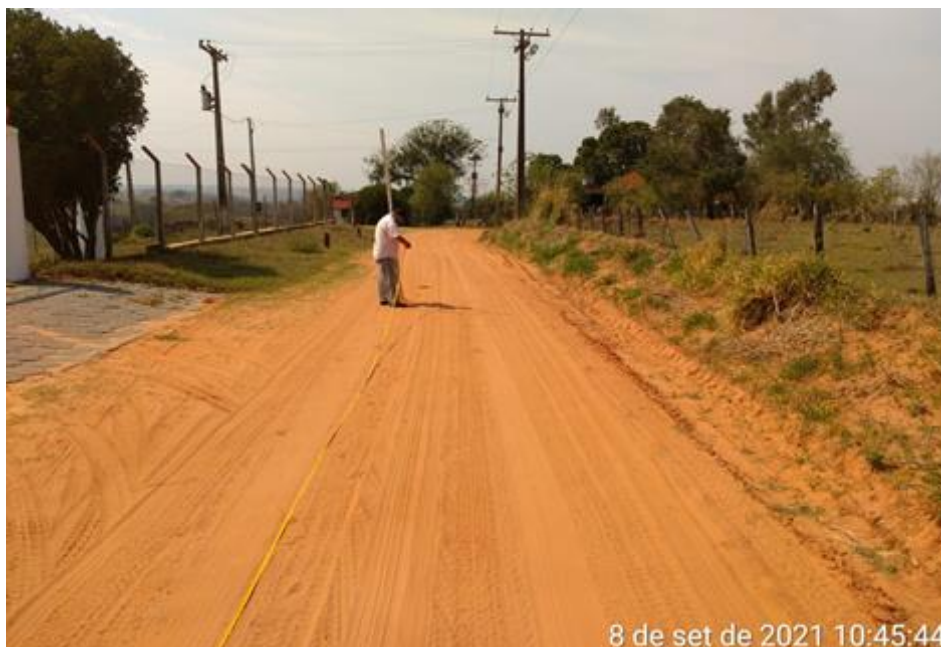
Imagem 6. Estrada do Condomínio Santa Fé, com leito encaixado, presença de barrancos laterais e apresentando acúmulo de areia nas partes baixas.
