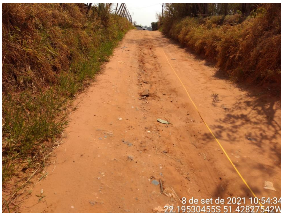
Imagem 5. Estrada do Condomínio Santa Fé, com leito encaixado, ausência de estruturas de direcionamento de águas e apresentando processo erosivo.
