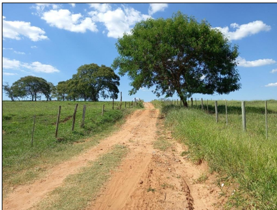
Imagem 2. Derivação da Estrada do Banco da Terra com estruturas ineficientes com formação de ravinas, leito encaixado.
