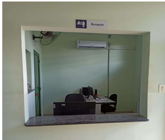
Espaço que necessita de vedação com abertura para passagem de documentos (recepção)
