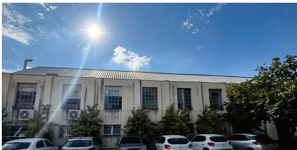
VIDROS EXTERNOS COM EXPOSIÇÃO À RISCO
