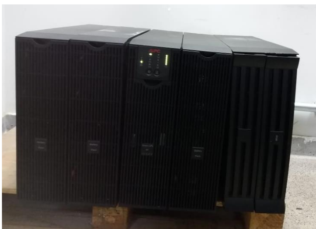
Figura1 - Nobreak principal junto com o banco de baterias.
