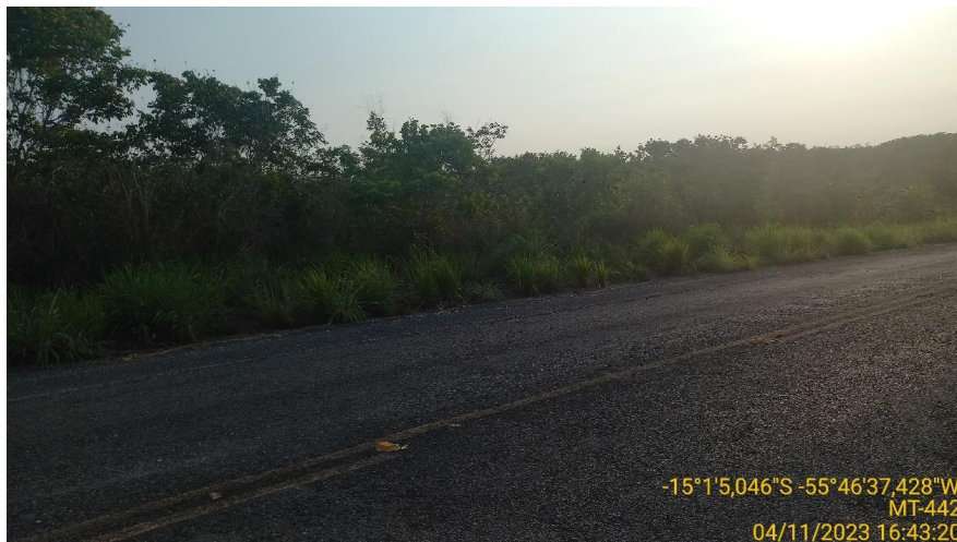
Figura 04 – Condições atuais do pavimento, autor próprio – 2023.
