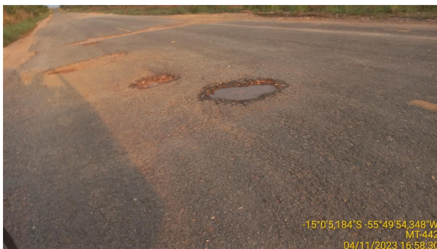
Figura 09 – Condições atuais do pavimento, autor próprio – 2023.
