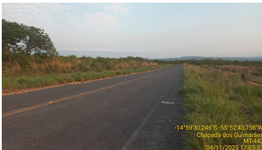
Figura 12 – Condições atuais do pavimento, autor próprio – 2023.
