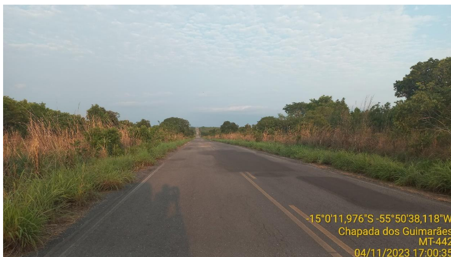
Figura 10 – Condições atuais do pavimento, autor próprio – 2023.
