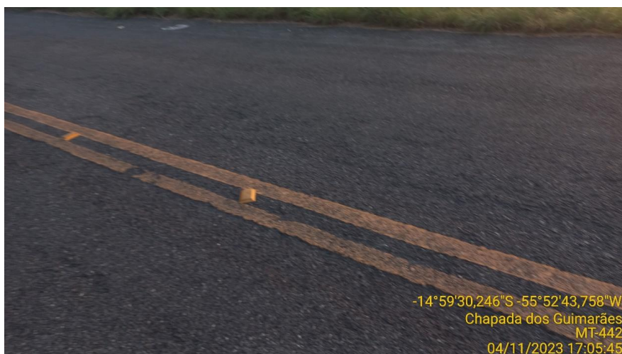
Figura 11 – Condições atuais do pavimento, autor próprio – 2023.
