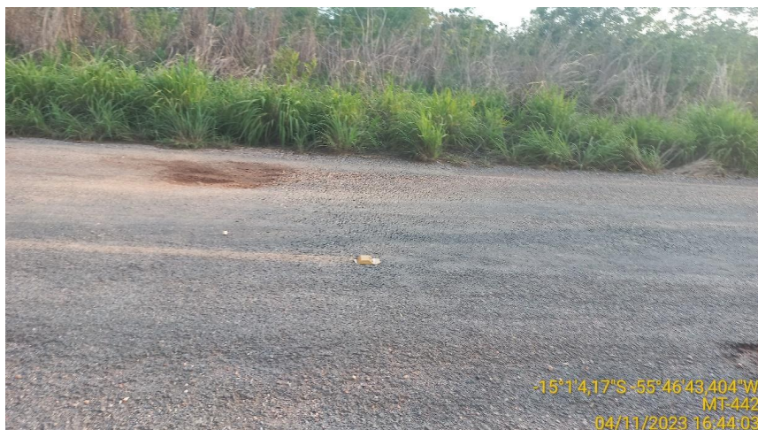
Figura 05 – Condições atuais do pavimento, autor próprio – 2023.
