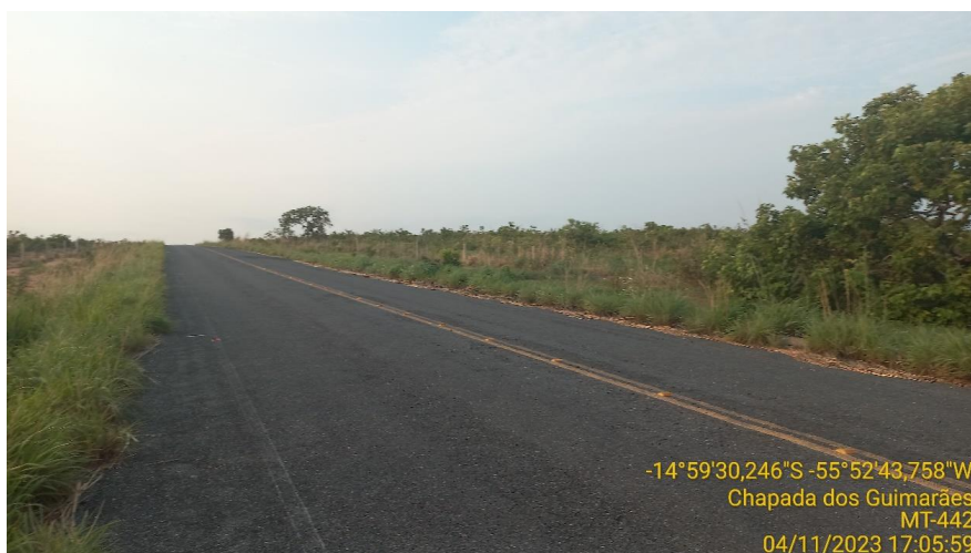
Figura 13 – Condições atuais do pavimento, autor próprio – 2023.
