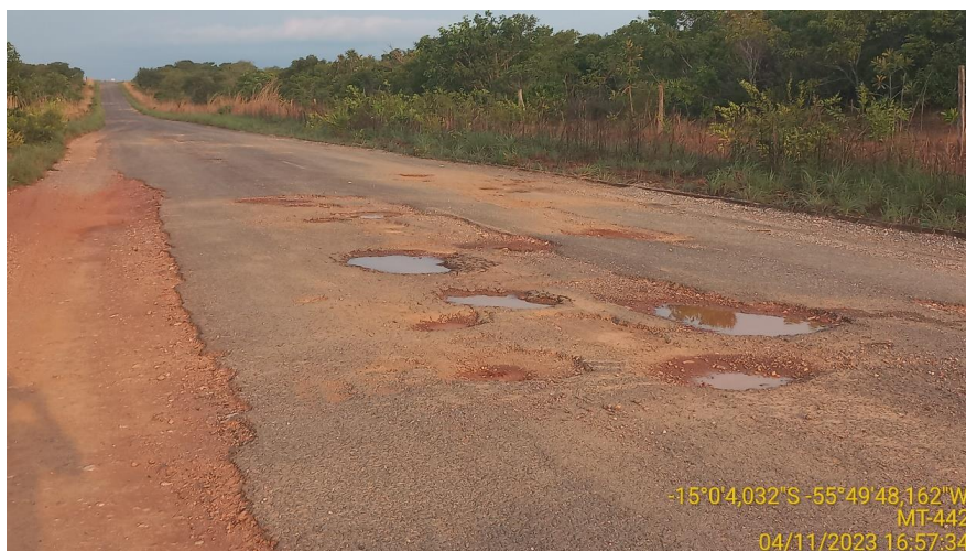
Figura 08 – Condições atuais do pavimento, autor próprio – 2023.
