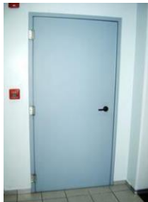
Porta corta-fogo simples para saída de emergência.
